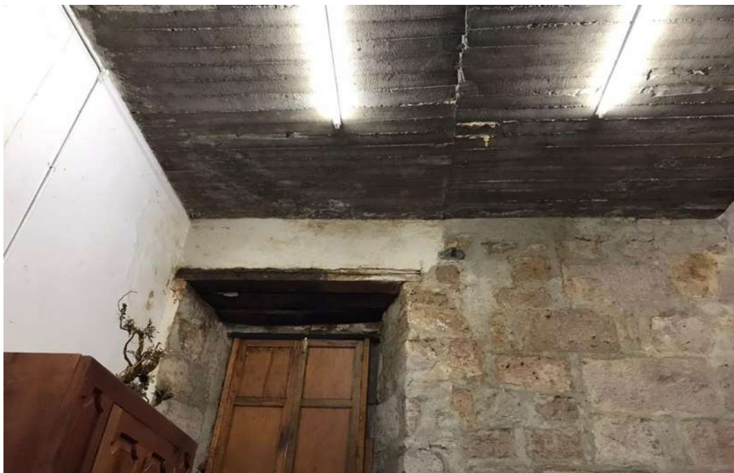
Imagen 13: Fotografía actual del techo donde se encuentran resguardadas las cajas del AHPSMM. Se puede ver cierto tipo de humedad reflejado en la pared, la ventana y en el techo.
