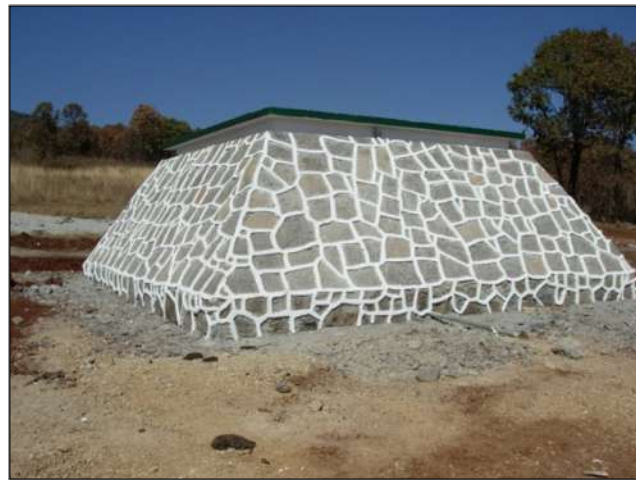
Tanque superficial para la distribución del agua.
