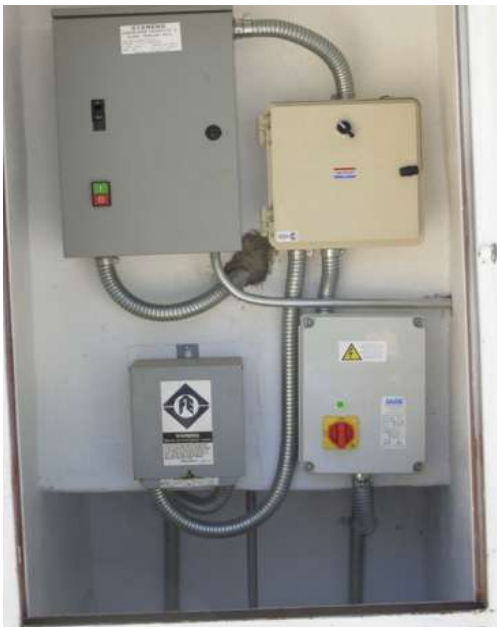
Arrancador y controles del pozo.
