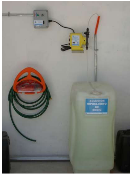
Equipo de desinfección mediante hipoclorito de sodio
