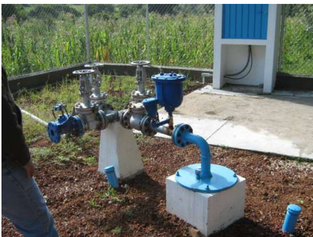
Tren de piezas especiales del pozo
