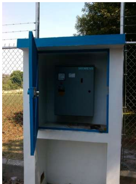
Arrancador eléctrico del pozo
