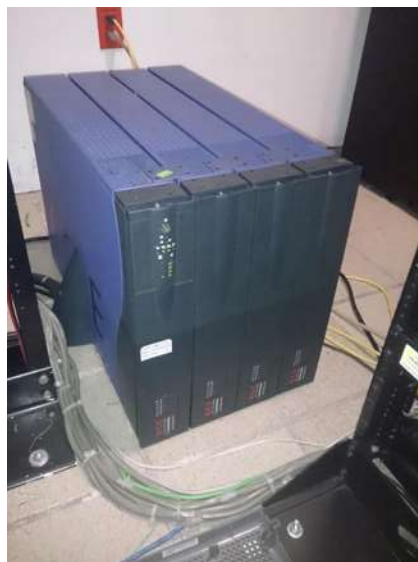
(b) UPS del sistema de telefonía
