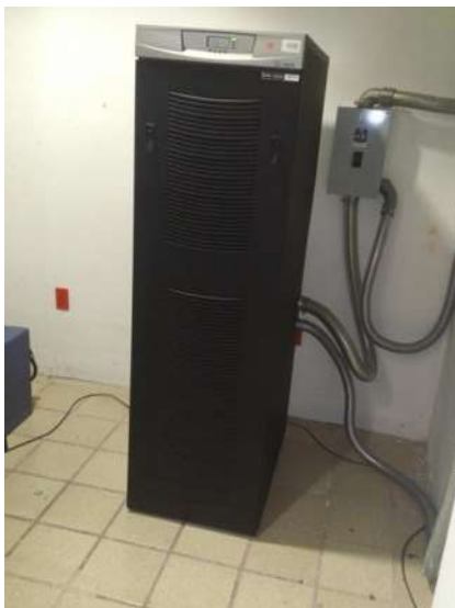
(a) UPS del cuarto de comunicaciones
