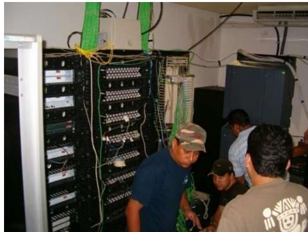
Figura 4.12 desconexión del cableado para limpieza
