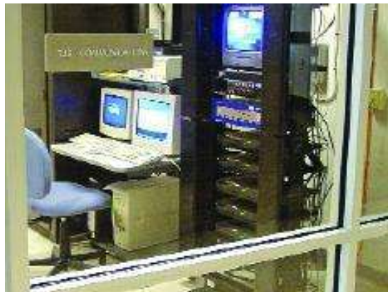
Figura 2.1 Cuarto de comunicaciones clase 1
