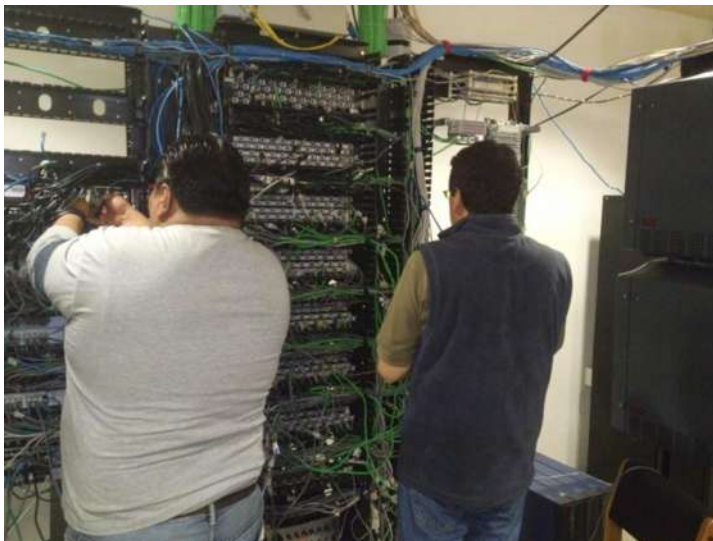
Figura 4.10 desconexión del cableado
