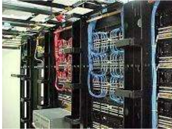
Figura 2.2 Cuarto de telecomunicaciones clase 2
