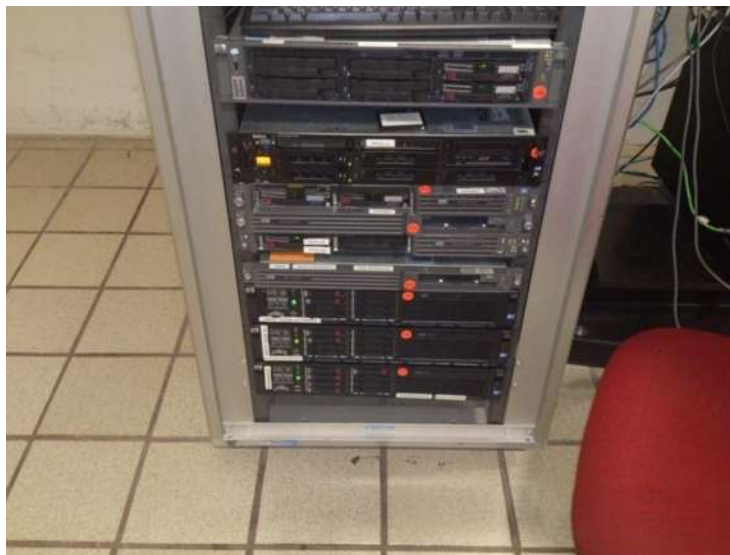
Figura 4.2 Rack de servidores
