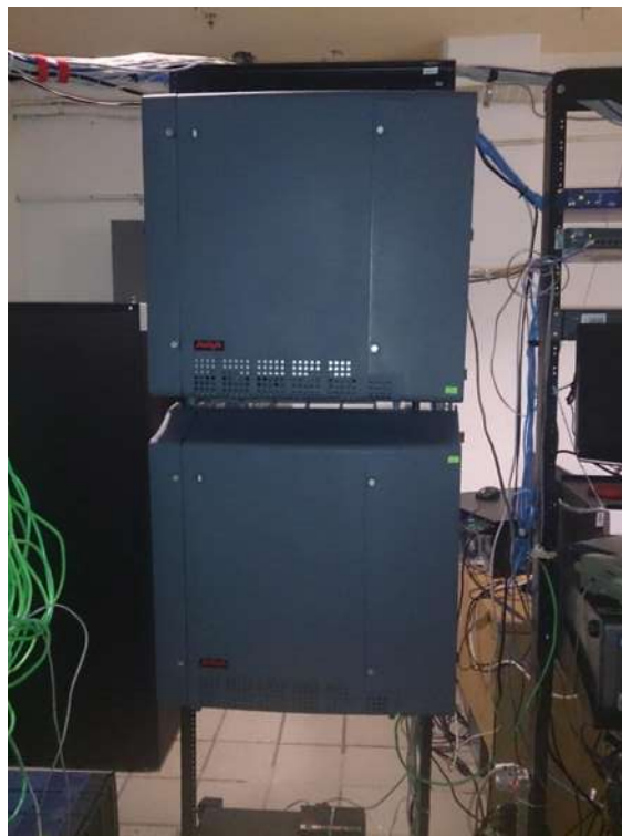
Figura 4.5 conmutador de telefonía
