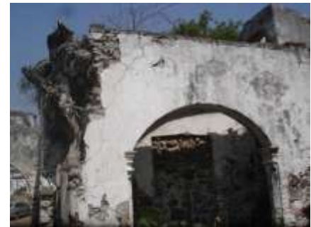
Figura 6. Vista del estado de deterioro en el que se encuentra la ex hacienda.
