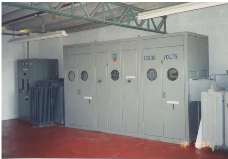
Figura 5.1 Subestación compacta con sección de acometida principal en 13,200 volts y sus secciones de apertura con y sin carga.
