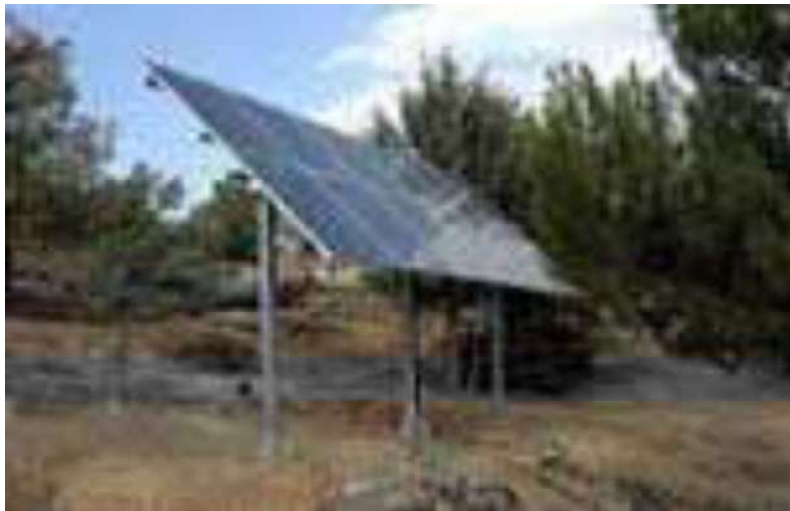
Figura 2.16 Panel fotovoltaico en mástil.
