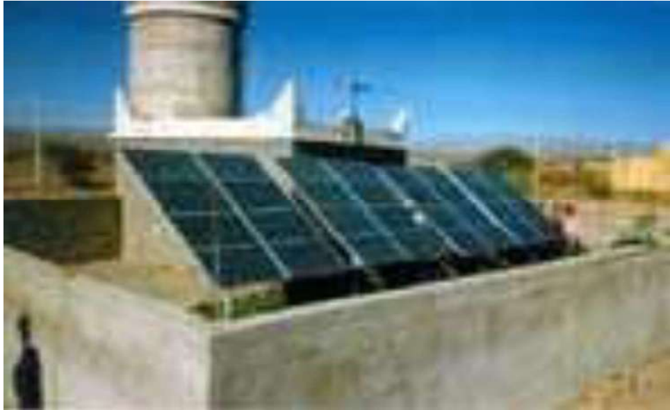
Figura 2.17 Panel fotovoltaico sobre un tejado
