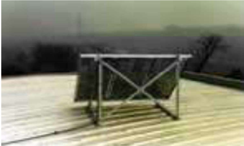
Figura 2.15 Panel Fotovoltáico en Bancada
