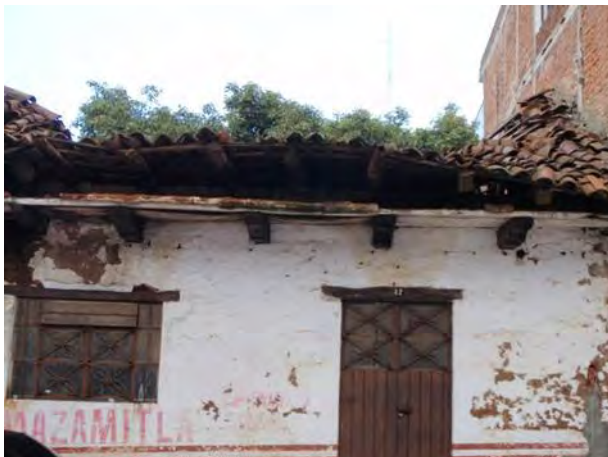
Figura 134. Vivienda vernácula en mal estado de conservación dentro de la zona patrimonial. Fuente: Foto tomada por la autora.
