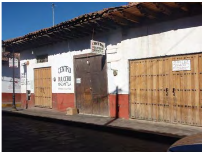
Figura 128. Inmueble sobre calle principal, sufrió el cambio de dos de sus vanos, al centro conserva la puerta original, mientras las puertas laterales son los vanos modificados para obtener puertas amplias con la puerta prototipo, este ejemplo muestra también el cambio propiciado por el cambio de uso de suelo. Fuente: Foto tomada por la autora.
