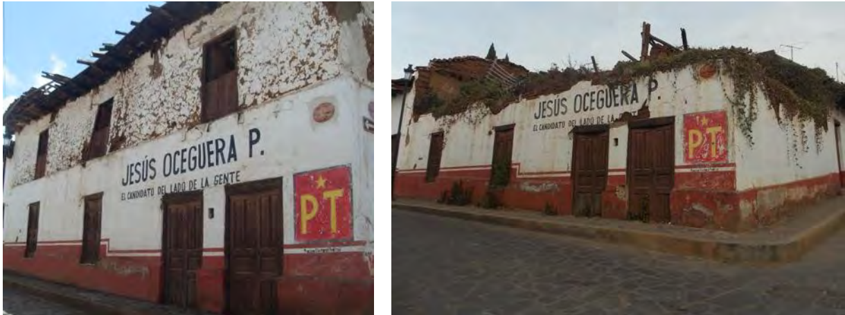
Figura 131. Monumento histórico que muestra deterioro progresivo. Fuente: Fotos tomadas por la autora [izquierda, 2011; derecha, 2013].
