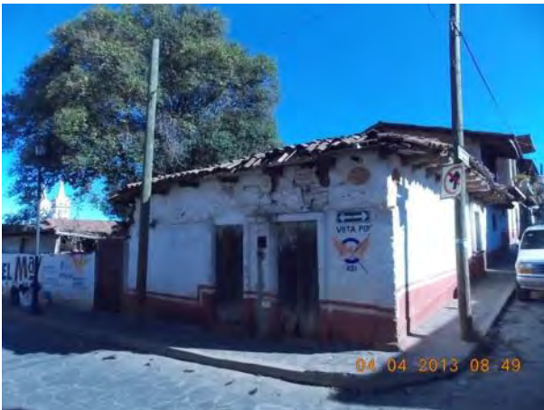
Figura 106. Edificación en mal estado de conservación. Fuente: Foto tomada por la autora.
