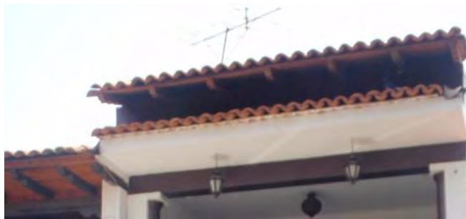
Figura 127. Sobre posicionamiento de un tejado en un original o “menos apropiado” en monumento histórico. Fuente: Foto tomada por la autora.
