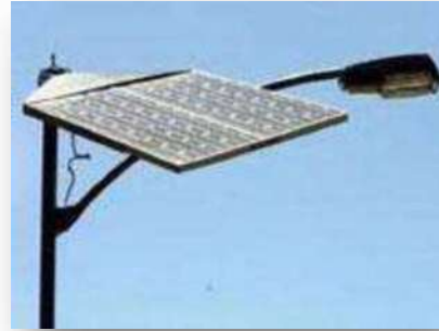
Figura 3.3 Una celda solar para utilización iluminación de calles.
