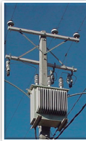
Figura 2.9 Transformador de distribución tipo poste.
