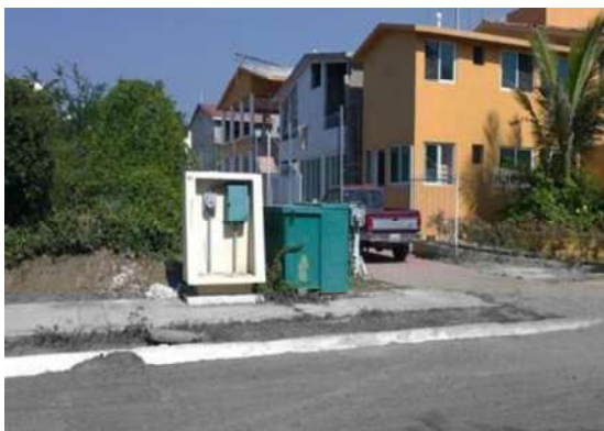
Figura 4.5 Transformador de Alumbrado Público con medidor instalado
