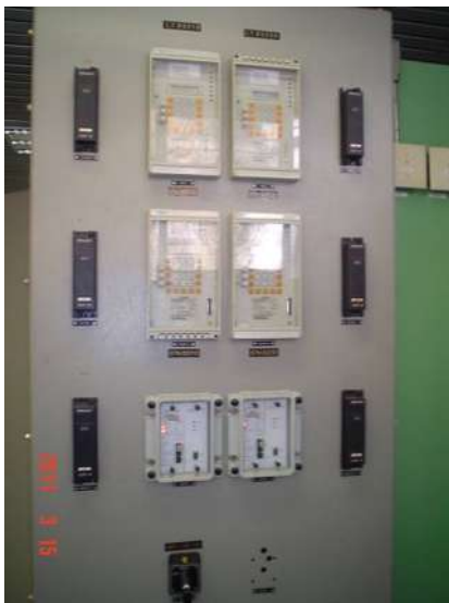
Figura 3.6 Tablero de Líneas Cortas CPT.
