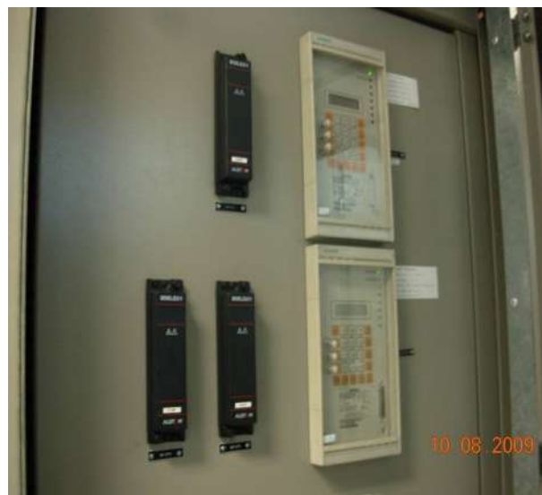
Figura 3.7 Tableros de Línea Convencional CPT.
