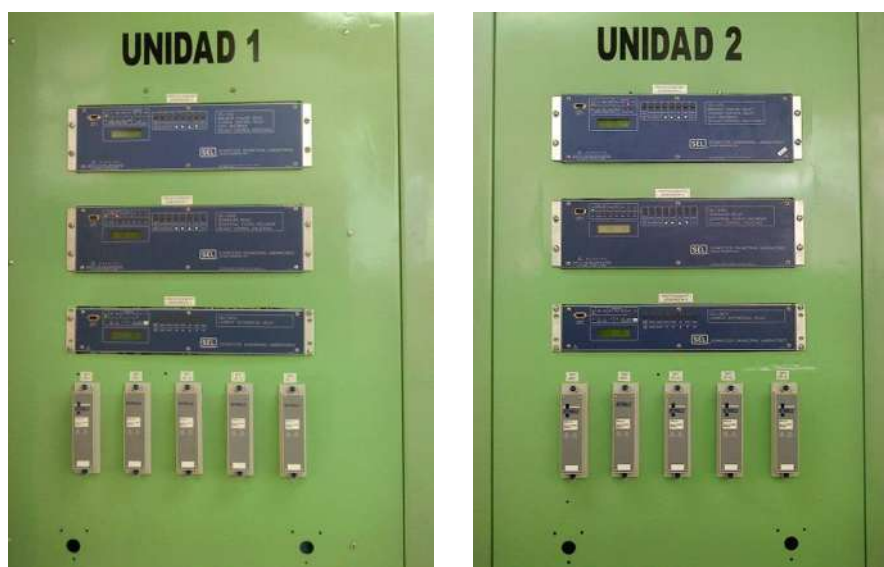
Figura 4.2 Tableros Adicionales de Protección de Generador.
