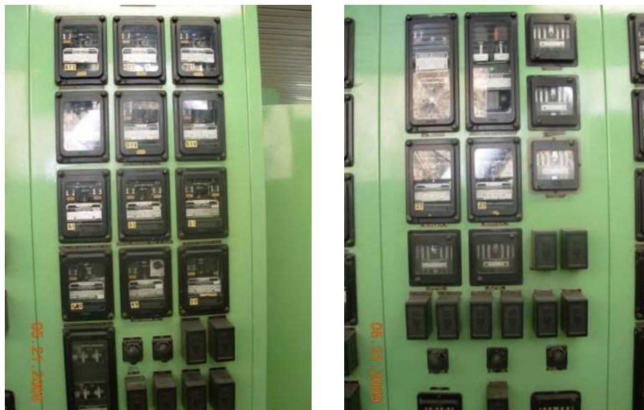
Figura 4.1 Tableros de Protección Electromecánicas de Generador C.H. Cupatitzio.
