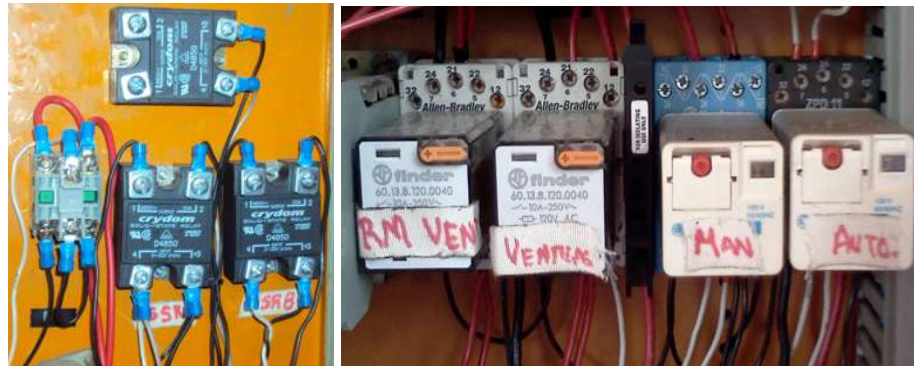
Figura 4.20 Relevadores de Estado Solido y Control del Selector.
