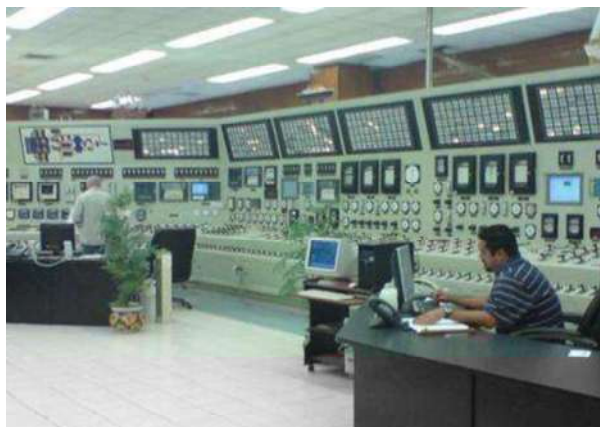
Figura 5.8 Sala de control.
