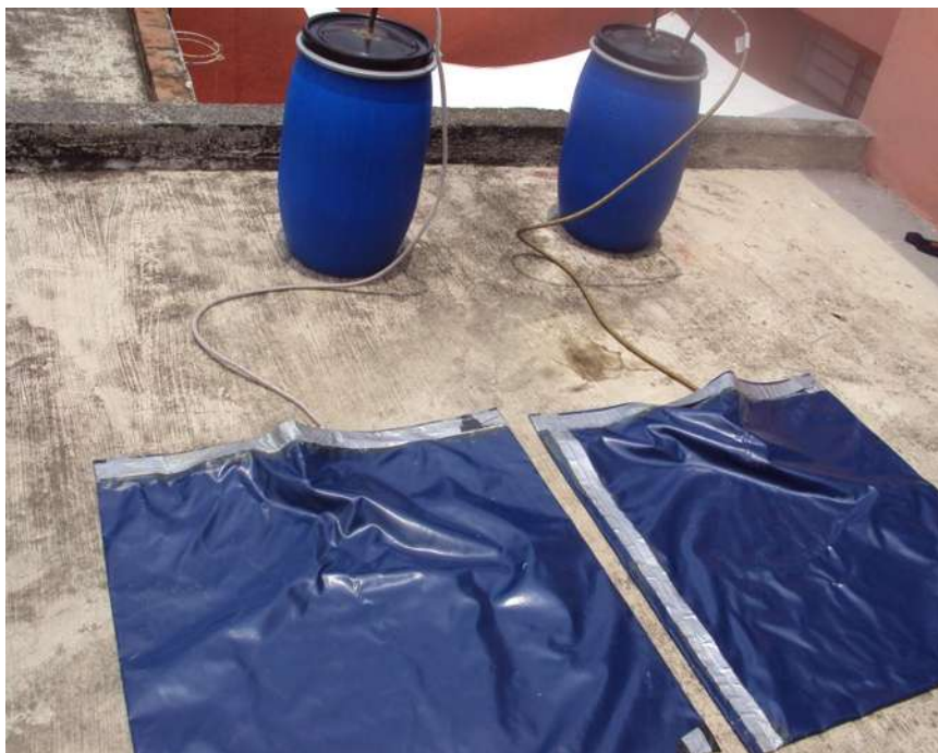
Figura 4.15 Presentación de los Biodigestores.
