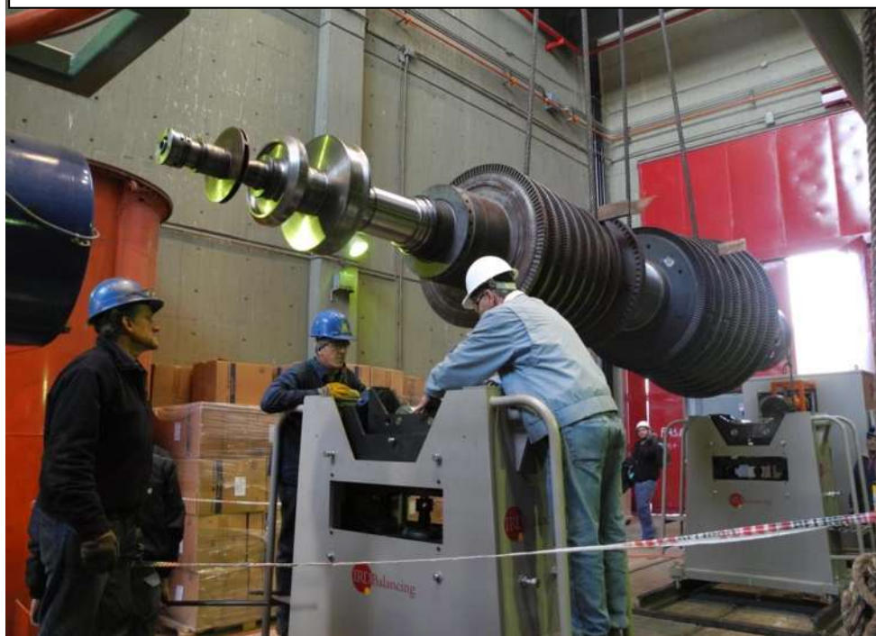
Fig. 4.4 Las maniobras anteriores al balanceo de grandes rotores deben ser de gran cuidado y comúnmente toman la mayor parte del tiempo empleado en las labores de esta especialidad
