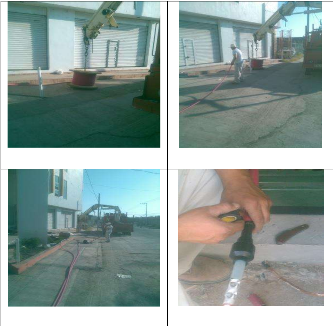
Figura 57 "Ratoneado", cableado de media tensión y codo de media tensión
