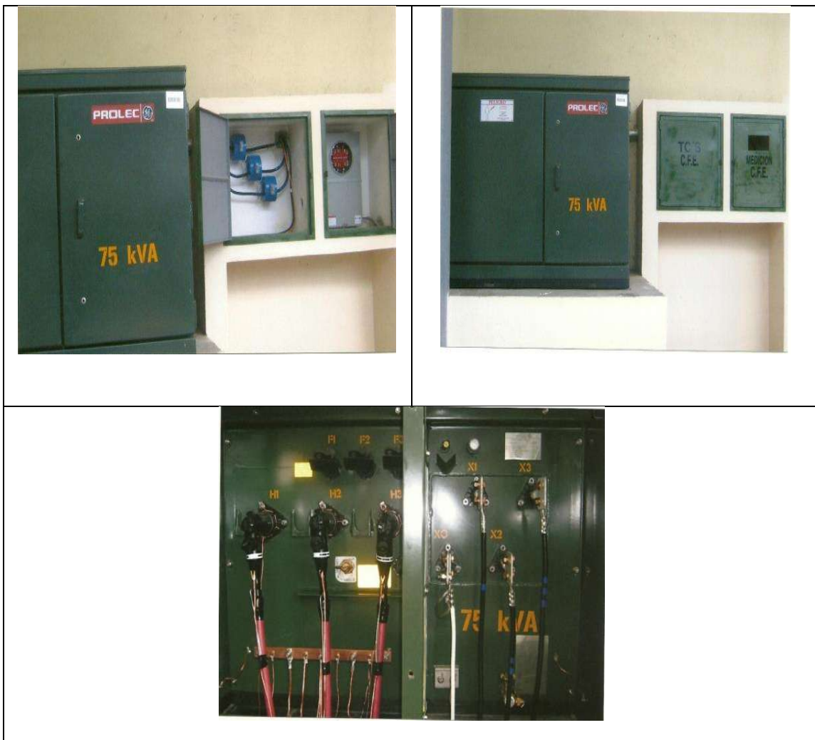
Figura 59 Vista interna de conexiones del transformador, vista de nichos de medición conteniendo TC's
