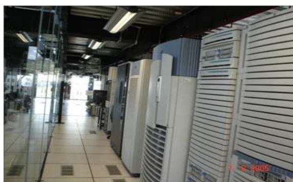
Figura 5 Centro de Cómputo Primario (CCP)
