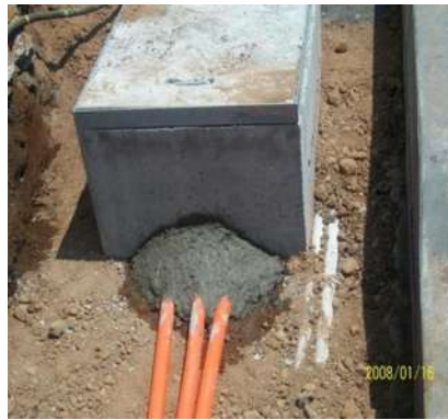
Figura 27 Ductos de Acometidas cfe, de Alumbrado y Tele cable.
