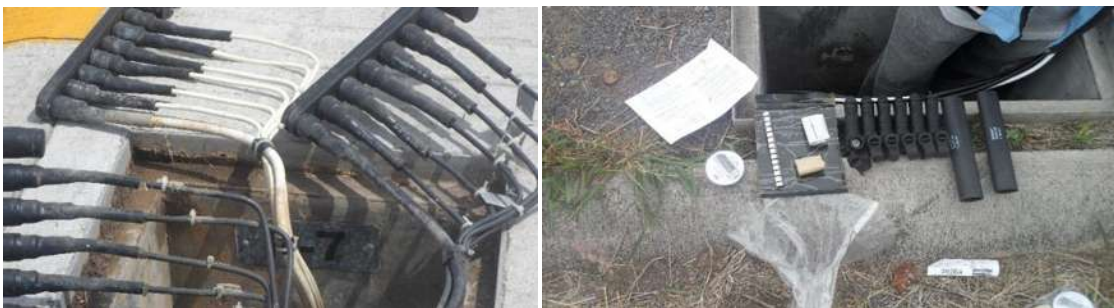
Figura 39 Accesorios de Baja Tensión
