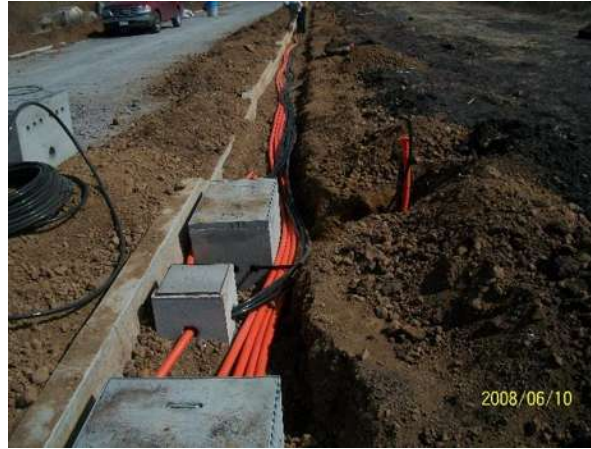
Figura 32 Ductos de tele cable, Acometidas y Alumbrado
