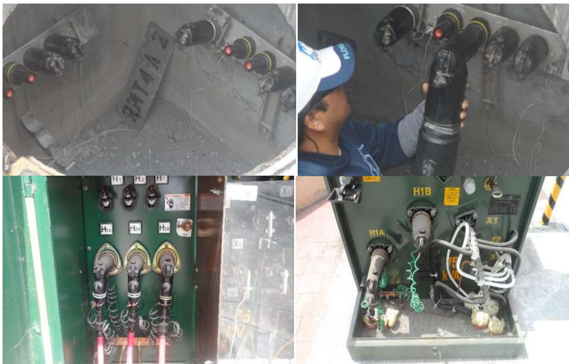
Figura 37 Accesorios de media tensión Instalados en transformador 3Øy 1Ø
