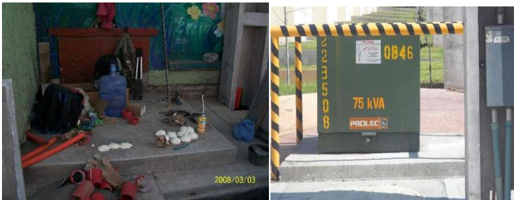
Figura 33 Base Para Transformador
