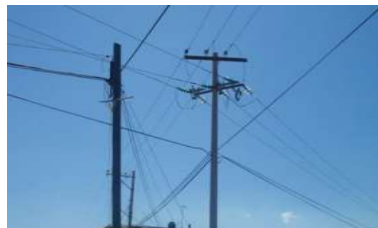
Figura 2 Combinación Red Eléctrica, Red Telefónica y Tele cable
