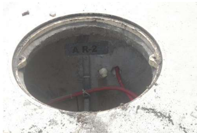
Figura 35 Identificación de registro Media Tensión
