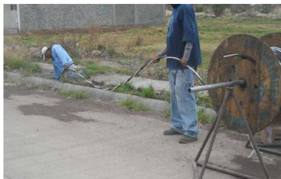
Figura 38 Cableado der la red de baja tensión
