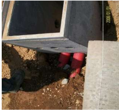
Figura 21 Nivelado de Registro de Baja Tensión.
