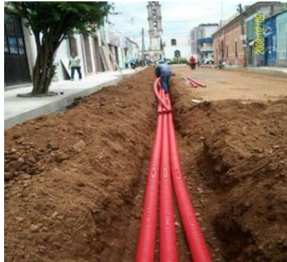
Figura 13 Ductos Para Línea de Media Tensión
