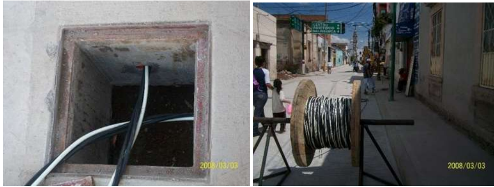
Figura 41 Cableado de Alumbrado Público
