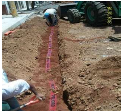
Figura 14 Indicador de Peligro Subterráneo.
