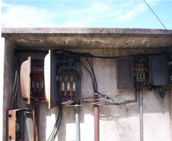
Figura 19 Vista de la concentración general de tableros en las pésimas condiciones que estaba nótese el tablero principal invertido así como las conexiones del bus principal Parte superior de los tableros estaban en pésimo estado las conexiones que derivaban hacia los salones de clases
