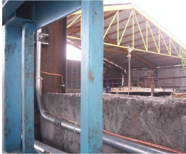
Figura 34 Cable de cobre desnudo Calibre 1/0 para aterrizar las estructuras metálicas del taller.
