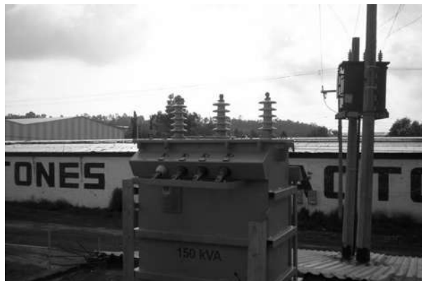
Figura 35 Vista del transformador de 150 KVA a instalar en la subestacion tipo azotea que reemplazara la subestacion tipo poste que se ve al fondo de la fotografía.
