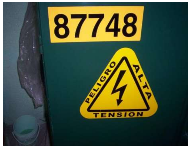
Figura 4 Transformador tipo pedestal de 150 kva para negocio de desperdicio el “Boni” en el fraccionamiento los angeles en Morelia Michoacán.
