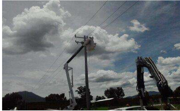
Figura 25 Vestido de subestación para transformador Trifásico de 30kva en Los Corrales Municipio de Zacapu Michoacán.
