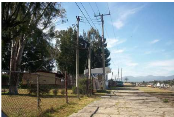
Figura 15 Vista general de la subestacion a la entrada de la escuela secundaria.
