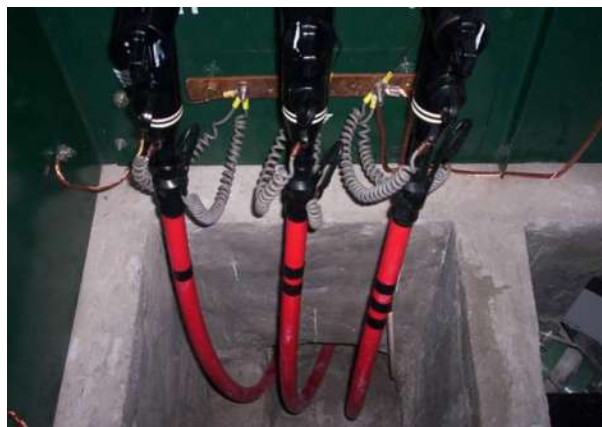
Figura 8 Vista de arreglo de conductores de media tensión a la salida del lavadero.
