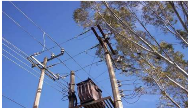
Figura 16 Vista de las condiciones en que se encontraba la subestacion de 75 kva en la escuela secundaria agropecuaria en la escondida Mpio. De Zacapu Mich. Nótese los Apartarrayos no existen. Y los herrajes son obsoletos por lo que hubo la necesidad de reemplaza
