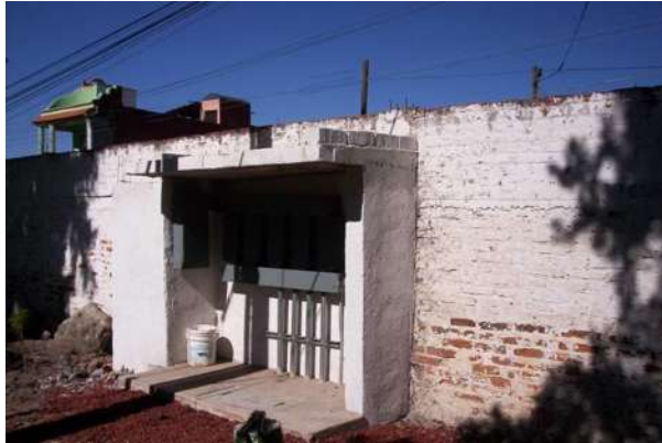
Figura 14 Vista de los tableros principales y derivados en la concentración general en la Escuela Ignacio Manuel Altamirano en Zacapu Mich.
