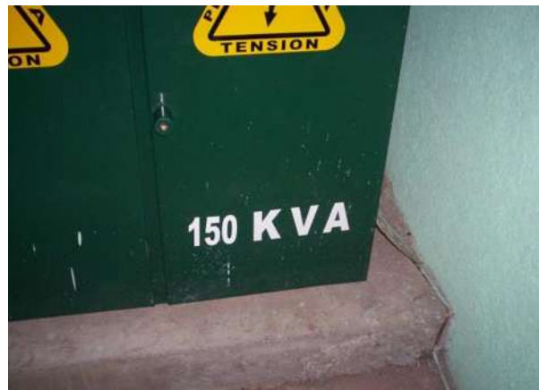
Figura 6 Vista del transformador tipo pedestal a instalar en el negocio de desperdicio denominado el "Boni" Ubicado en la calle pino del Fraccionamiento los angeles del municipio de Tarimbaro.
