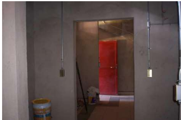
Figura 11 Vista parcial de la instalación eléctrica en los vestidores bajo las escaleras en el auditorio municipal de Zacapu Michoacán
