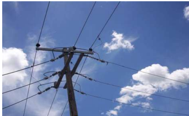
Figura 3 Vista donde se entronco la acometida en media tensión para la empresa productos de alambre nótese que hay otra acometida en media tensión para derivar a otra subestacion similar a esta.
