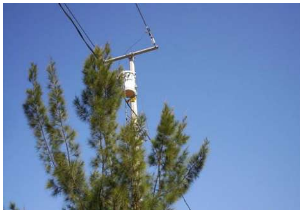
Figura 31 Vista del transformador de 15 kva monofásico de donde se alimentara al cliente en baja tensión con una acometida de 220 volts.
