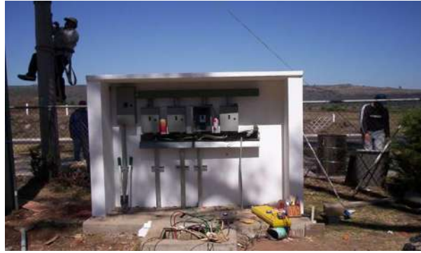
Figura 21 Vista de la concentración general de tableros en proceso de terminación Aquí se nota el tablero principal así como el ducto fuente que contiene el bus principal así como el bus carga en la parte baja de los tableros derivados y de aquí a ramalear a la carga de los salones
