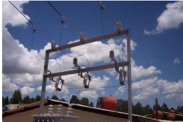
Figura 2 Vista de la subestación tipo azotea donde se notan los cortacircuitos y los Apartarrays propiedad de la empresa productos de alambre en la ciudad industrial Morelia.
