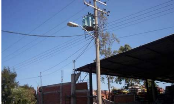
Figura 5 Vista del transformador en la nueva posición propiedad de C.F.E con el cual estaban suministrando la energía antes de instalar su propia subestacion ya que en su anterior ubicación no permitía la transición aero subterránea.
