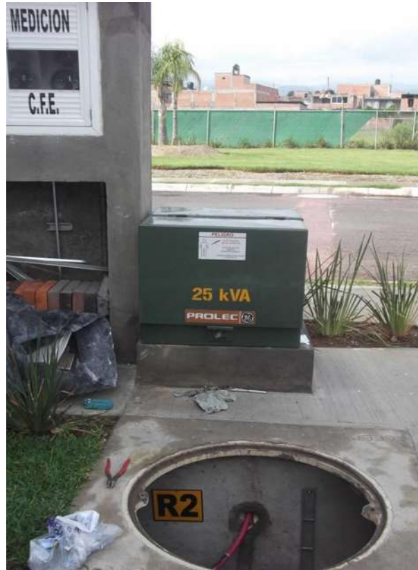
Figura 29 Vista parcial del registro de media tensión y transformador en el súper de abarrotes 7 Big Das en Zacapu.
