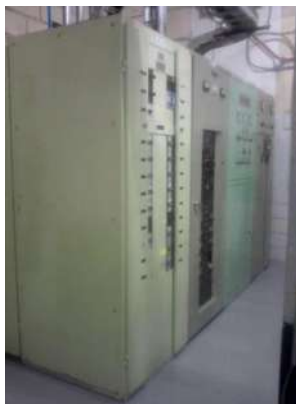
FIGURA 6 TABLERO DE DISTRIBUCIÓN DE CORRIENTE DIRECTA (CD)
