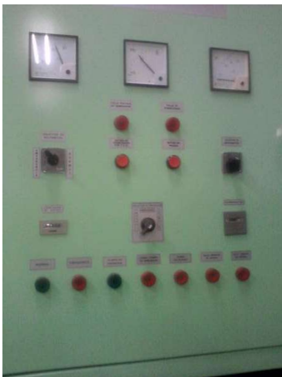
FIGURA 13 TABLERO DE CONTROL
