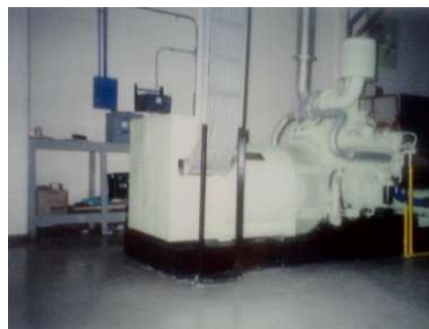
FIGURA 5 GRUPO ELECTRÓGENO (OTRA VISTA)
