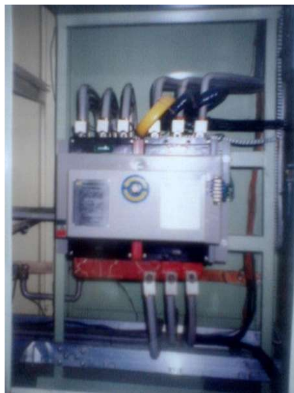
FIGURA 14 TABLERO DE CONTROL (VISTA INTERNA)
