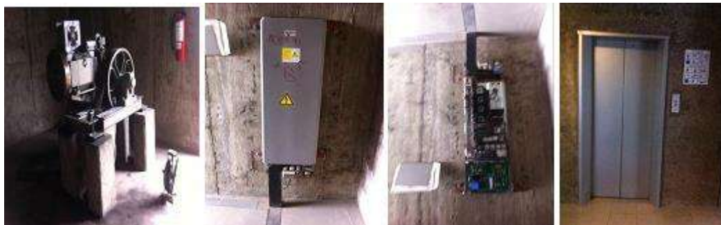
Figura 8 Equipo de Elevador
