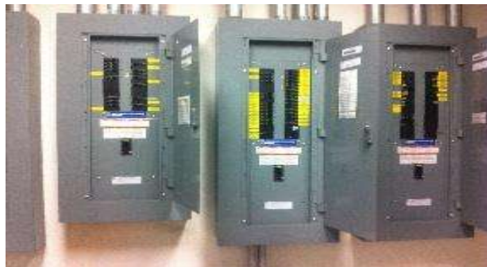
Figura 17 Tableros Aires Acondicionados
