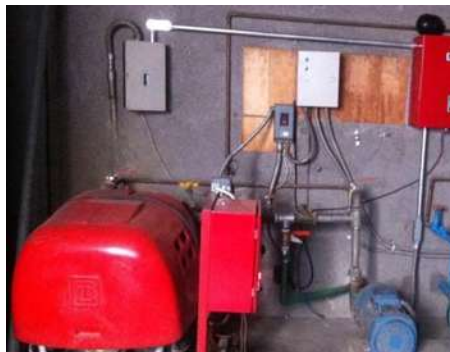
Figura 26 Bombas contra incendio
