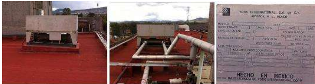
Figura 20 (Aire Acondicionado Central) Obsoleto
