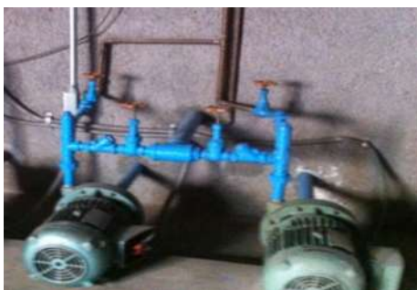
Figura 25 Bombas de Agua
