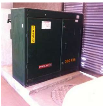
Figura 12 Subestación de 300 KVA
