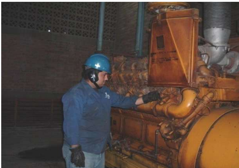
Figura 3 Planta de emergencia
