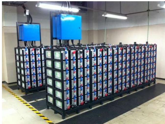
Figura 14 Baterías de Respaldo en caso de falla de C.A.
