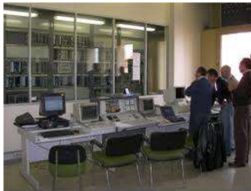
Figura 25 Sala de control de una Central telefónica tipo AXE
