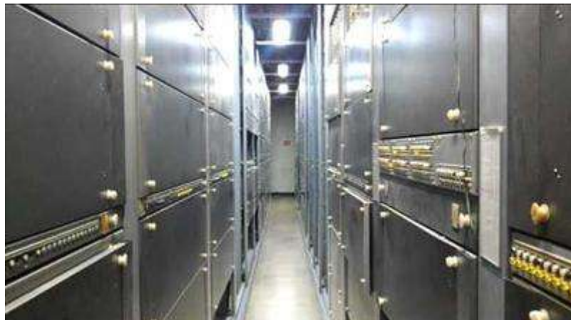
Figura 1 Vista de una Central telefónica Alcatel.
