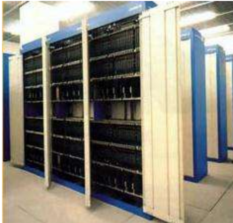
Figura 17 Bastidores de sala de equipo AXE
