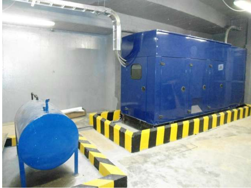
Figura 2.2.13 Cuarto de Planta de emergencia.
