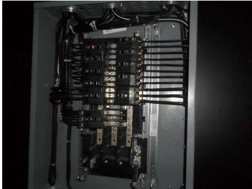
Figura 2.3.2 nuevo tablero de distribución.
