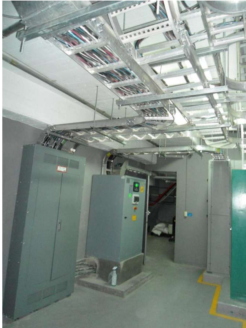
Figura 2.2.12 Cuarto de Eléctrico.
