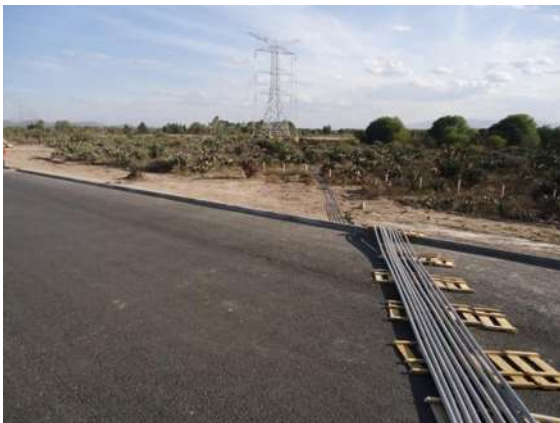
Figura 40 Evitar que cable conductor tenga contacto con el suelo
