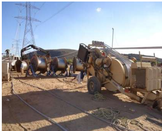
Figura 41 Equipo de tendido
