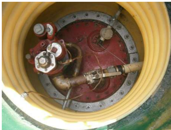
Figura 3.12 Entrada hombre de tanque de almacenamiento
