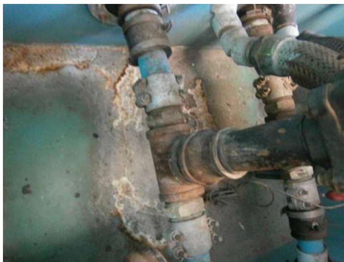
Figura 2.6 Tubería de alimentación y contenedor.
