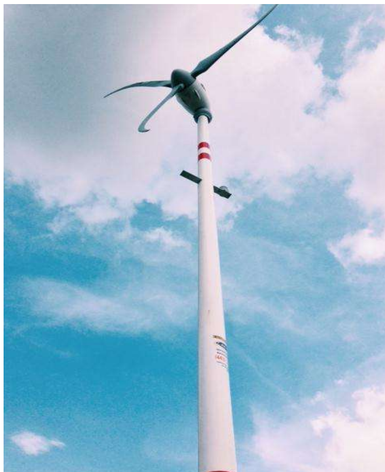
Figura 3. 4 Turbina eólica instalada Skystream 3.7.
