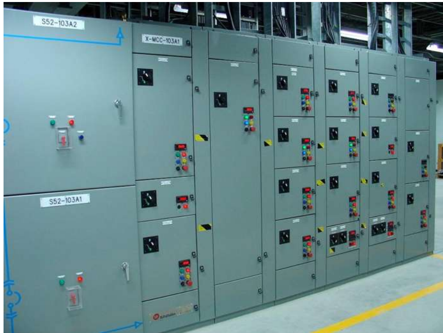
FIGURA 26.- CENTRO DE CONTROL DE MOTORES
