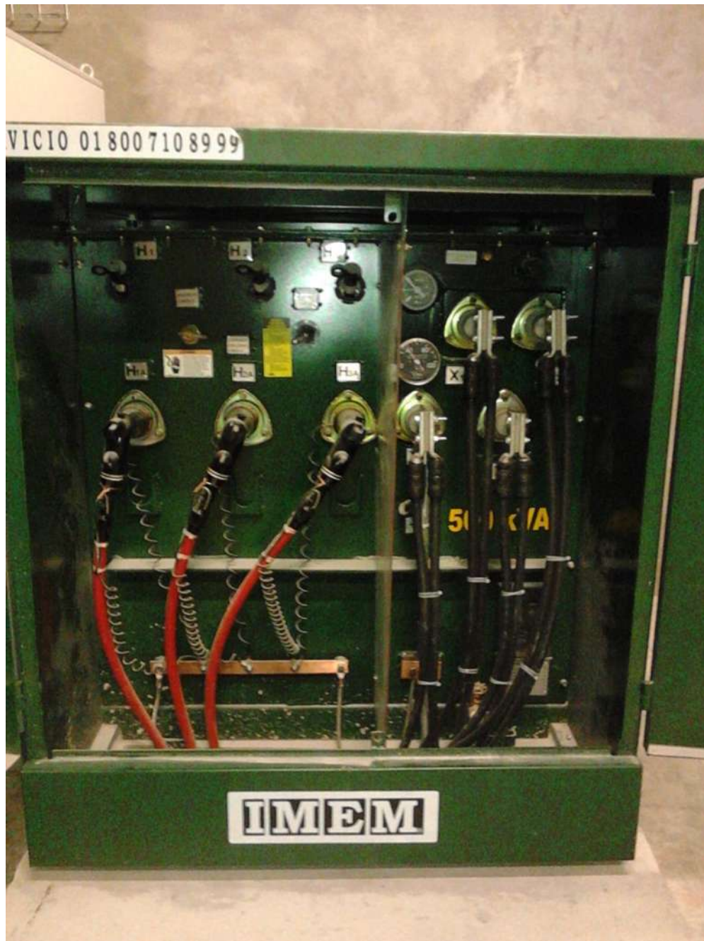
Figura 42.- Transformador pedestal de 500Kva, 13.2Kv-480/277V, para alimentación de cargas de áreas comunes.
