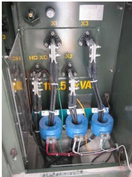
Figura 12.- Conexión de terminales en el lado de B.T. con los TC's instalados para el equipo de medición
