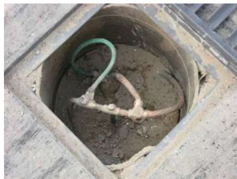
Figura 20.- Sistema de tierras, con los requerimientos solicitados con valores menores a 5 Ohms.
