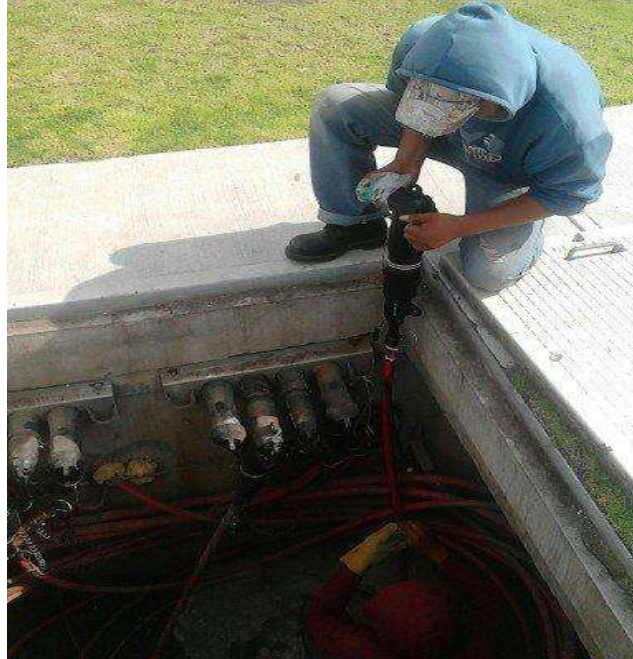
Figura 29.- Caja derivadora j4 combinada en 600 Amp y 200 Amp, en esta figura se muestra la instalación de un fusible para media tensión.
