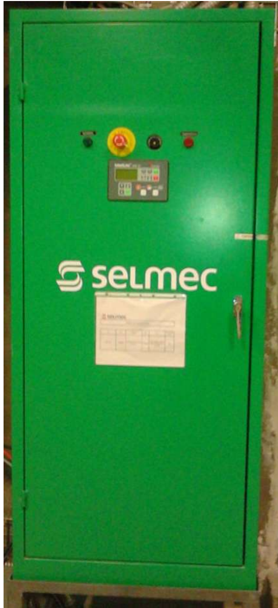
Figura 39.- Transfer automático para intercambio de suministro de energía.
