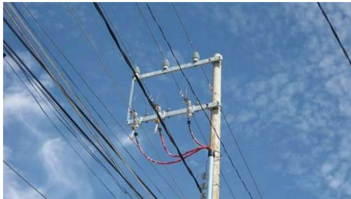
Figura 2.- Transición Aéreo – Subterránea
