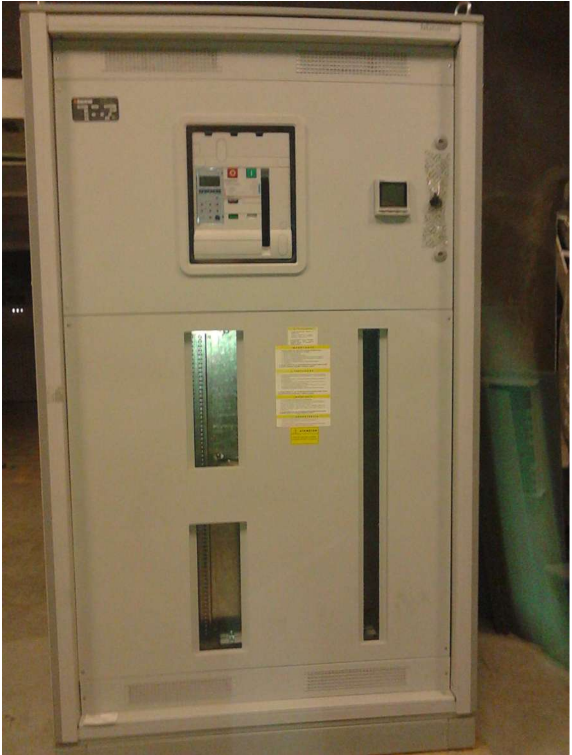
Figura 40.- Tablero de interruptor principal de 3x800Amp.
