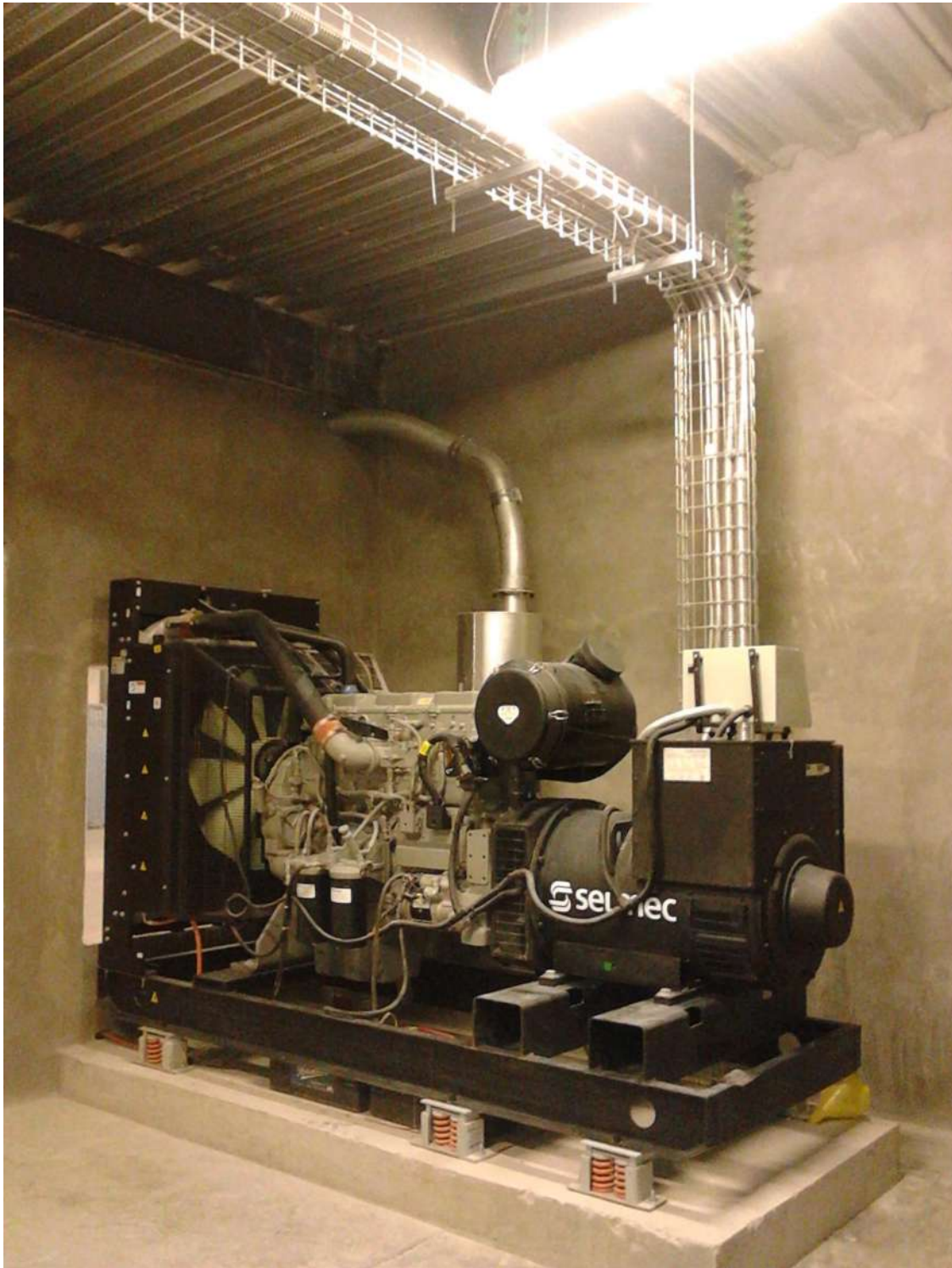
Figura 38.- Planta de emergencia de 350Kw a 480-277Volts de salida.
