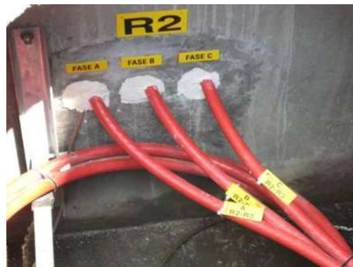
Figura 6.- Registro de media tensión.
