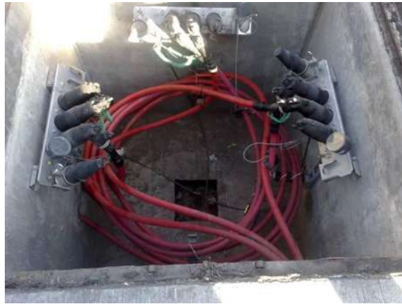
Figura 16.- Cajas derivadoras y codos de O.C.C. en 25 KV.
