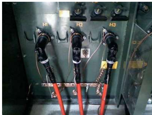
Figura 11.- Conexión de los codo O.C.C. en la subestación.
