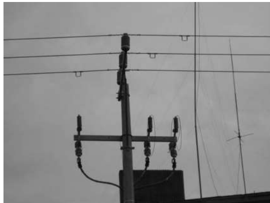
Figura 14.- Transición Aéreo - Subterránea.
