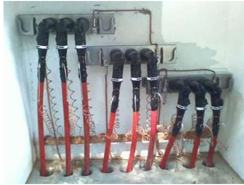
Figura 10.- Murete con cajas derivadoras y codos de O.C.C.
