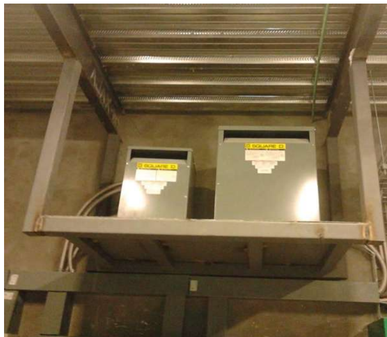
Figura 37.- Transformadores secos de 45 y 112.5 KVA, para alimentación de circuitos de áreas comunes.
