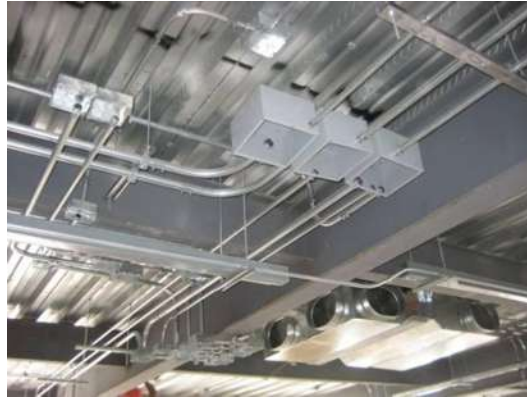
Figura 18.- Instalaciones eléctricas con tubo conduit galvanizado.
