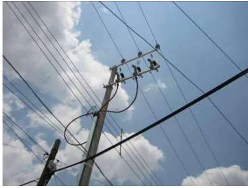
Figura 7.- Transición Aéreo - Subterránea.
