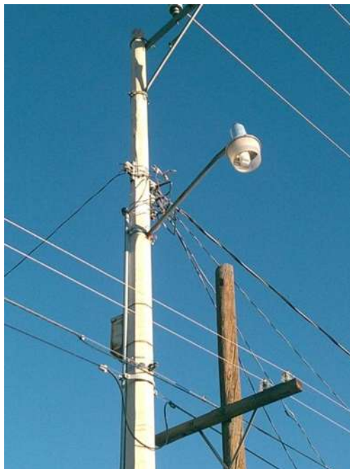
Figura 2.- Luminaria Suburbana de 65 watts
