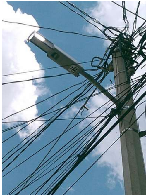
Figura 18.- Luminaria de Led 30 watts Marca Philips instalada a prueba
