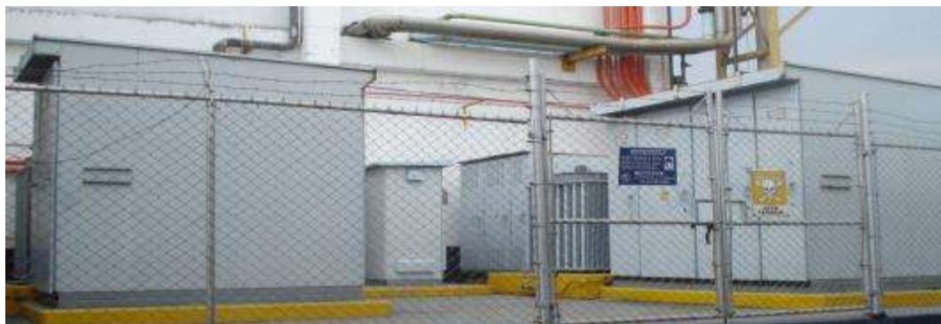
Figura 34.- Vista de Subestación DESTINTADO2
