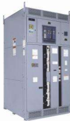
Figura 56.- Tablero de distribución QD- Pact para alimentación a convertidores de frecuencia.
