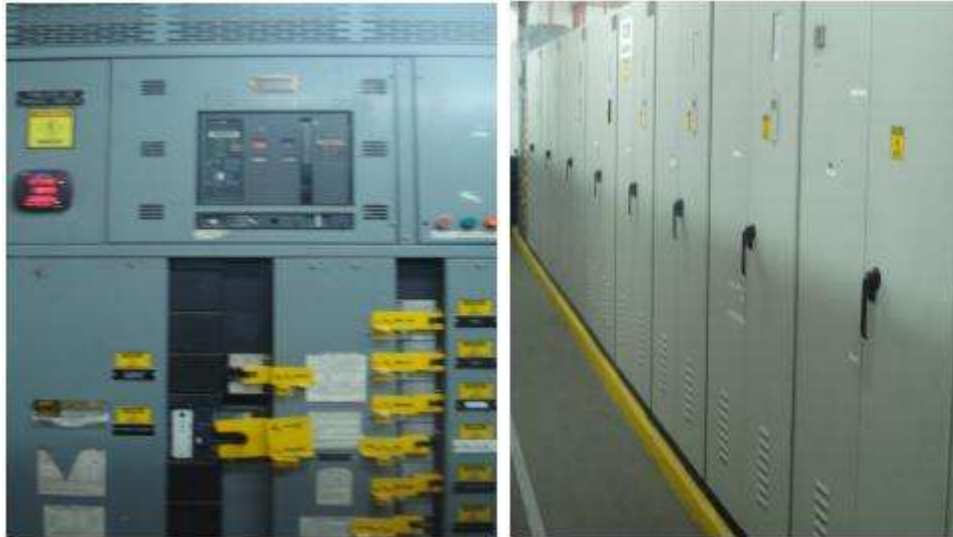
Figura 38.- Vista de CCM Variadores de Frecuencia.
