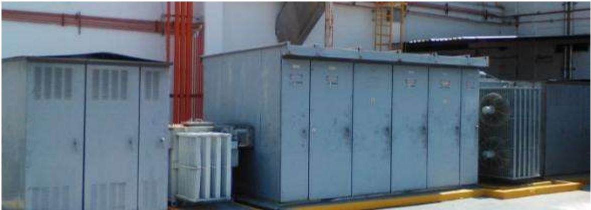
Figura 24.- Vista de Subestación Tissue.
