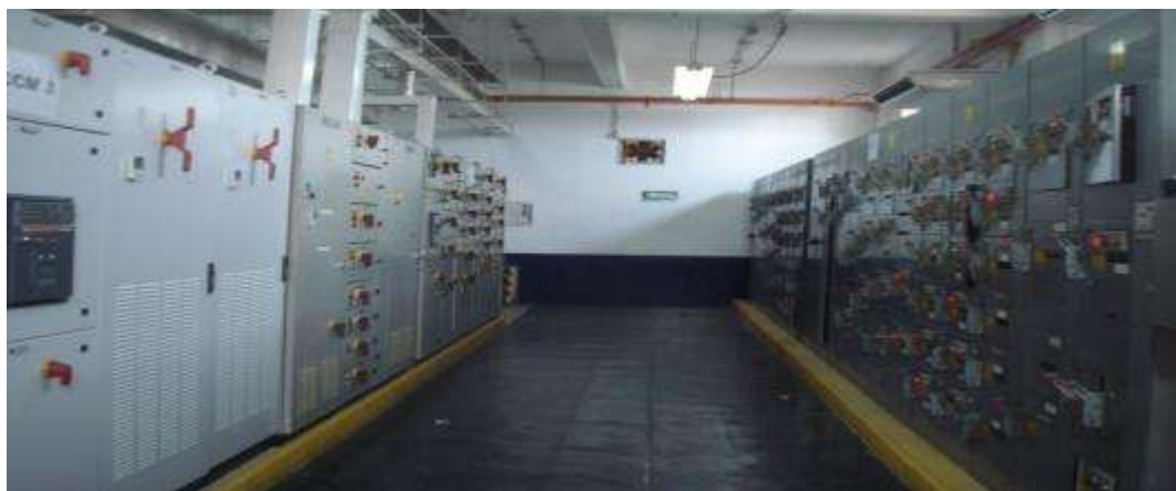
b) CCM-02 = 379 KVA c) CCM- 03 = 3992 KVA
