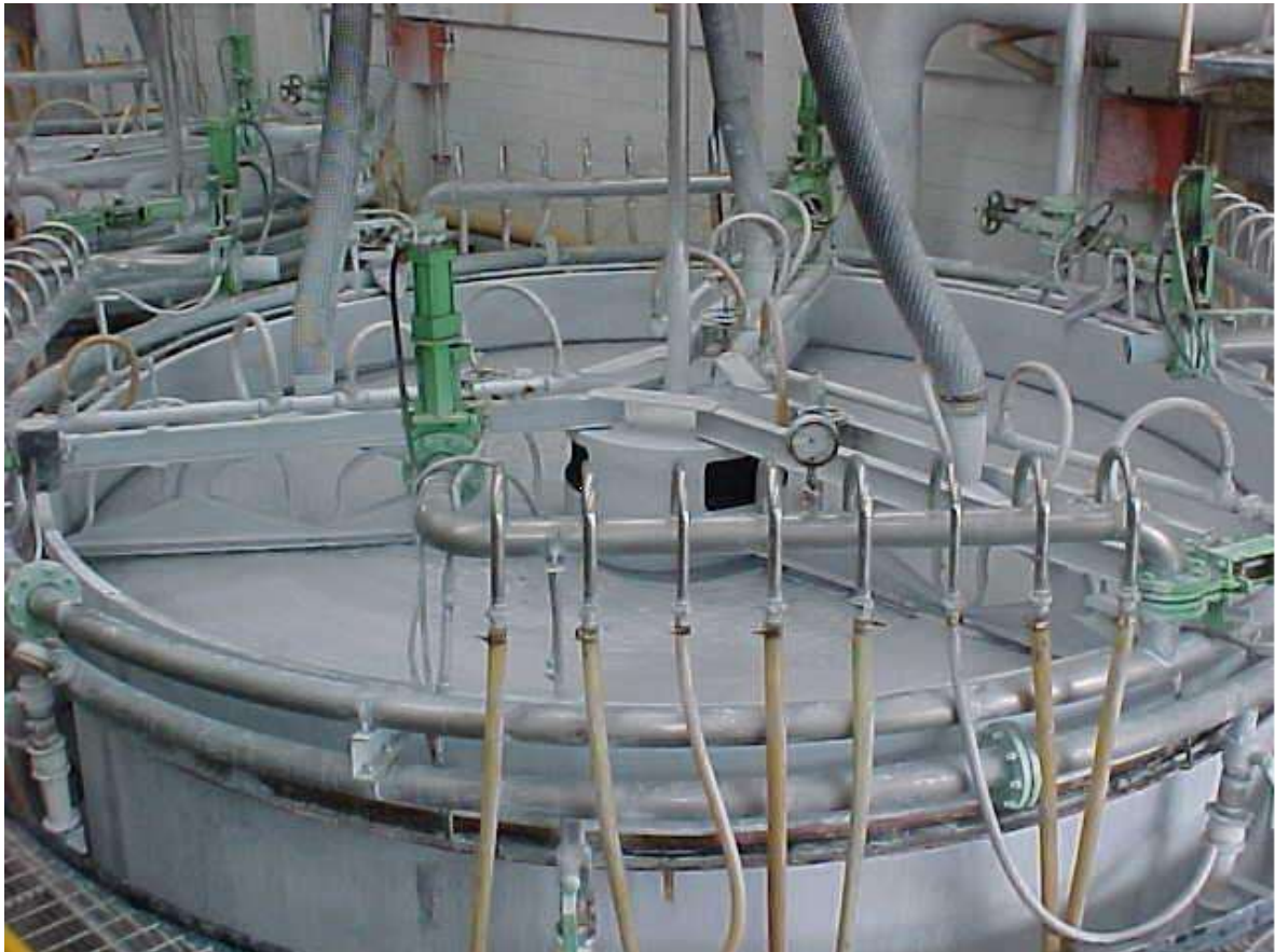
Figura 66.- Celda de Flotación DESTINTADO2 Uno
