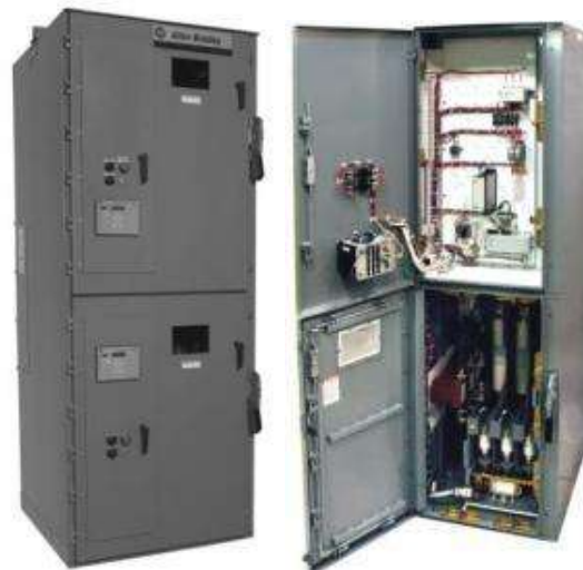
Figura 53.- Centro de control de motores en tensión media, marca ALEN- BRADLEY.
