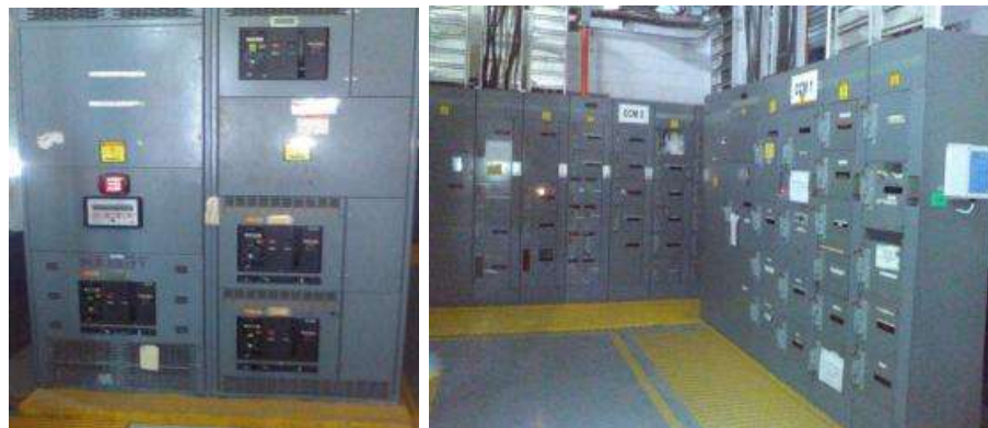
Figura 23.- Vista de CCM's Conversión
