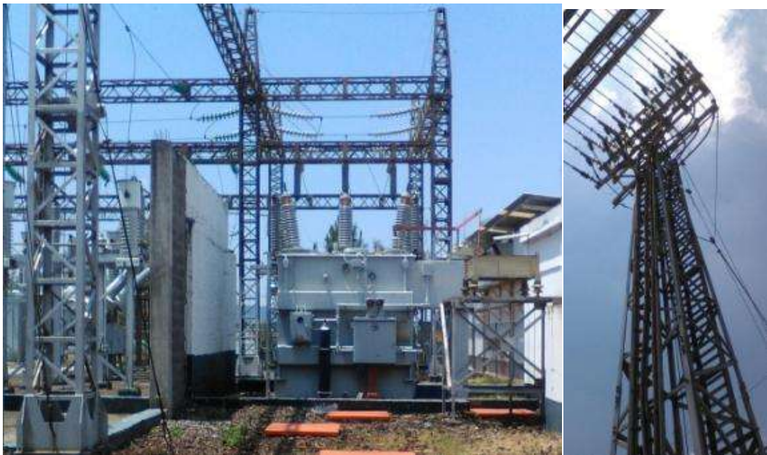
Figura 19.- Fotografías de Subestación Principal
