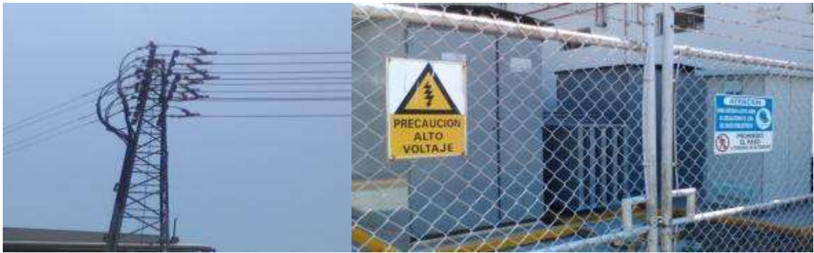
Figura 27.- Vista de Subestación Maquina Tissue parte dos.
