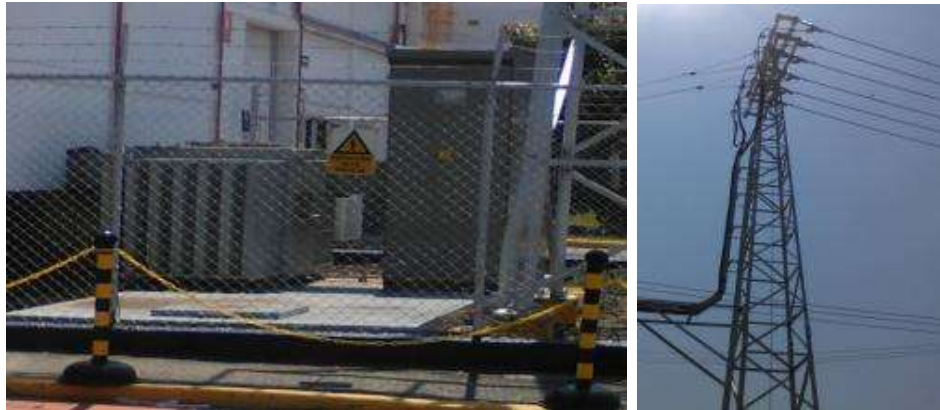
Figura 22.- Vista de subestación Conversión.
