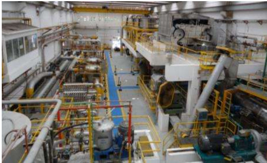
Figura 12.- Vista Panorámica Planta DESTINTADO2
