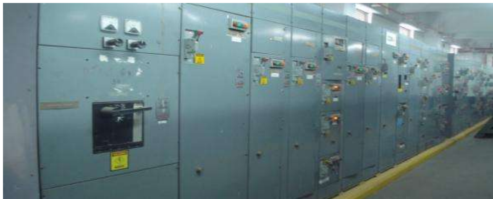
Figura 40.- Vista de CCM's
