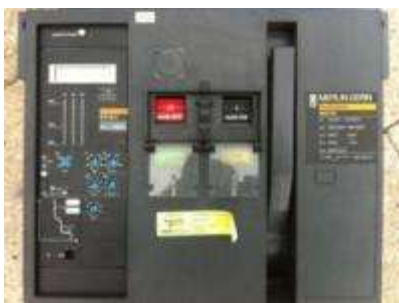
Figura 52.- Interruptores de potencia tipo M16H1 Masterpact
