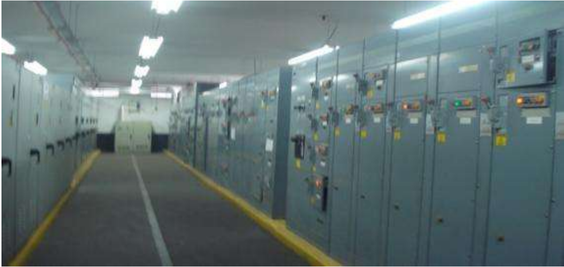
Figura 43.- Vista de CCM's
