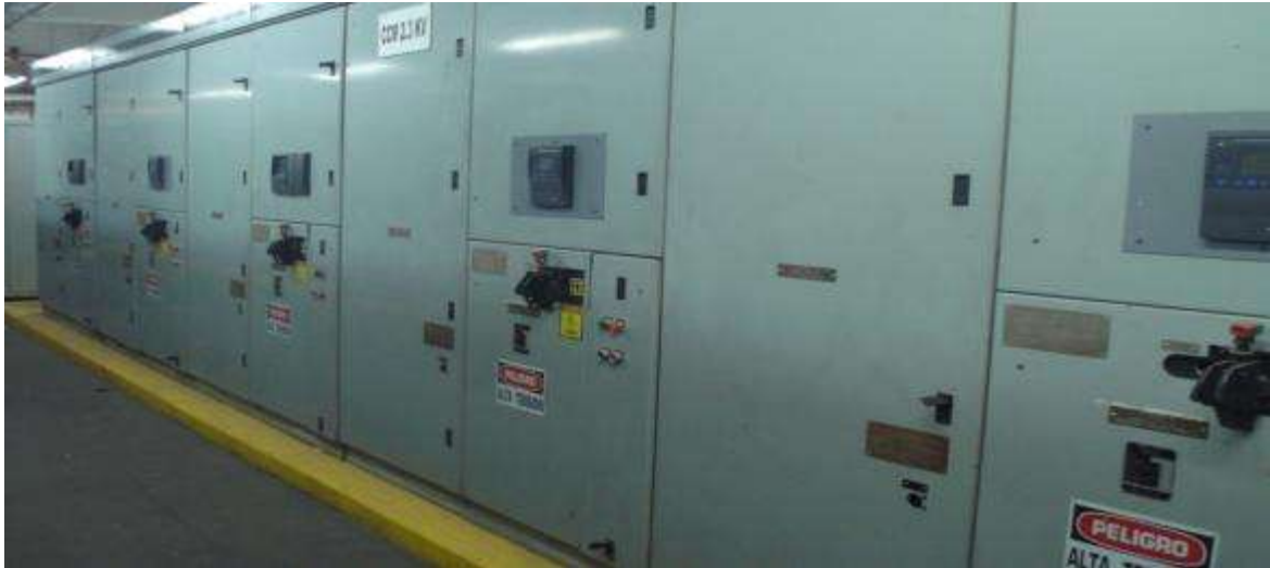
Figura 45.- Vista de CCM''s 07 DESTINTADO2.
