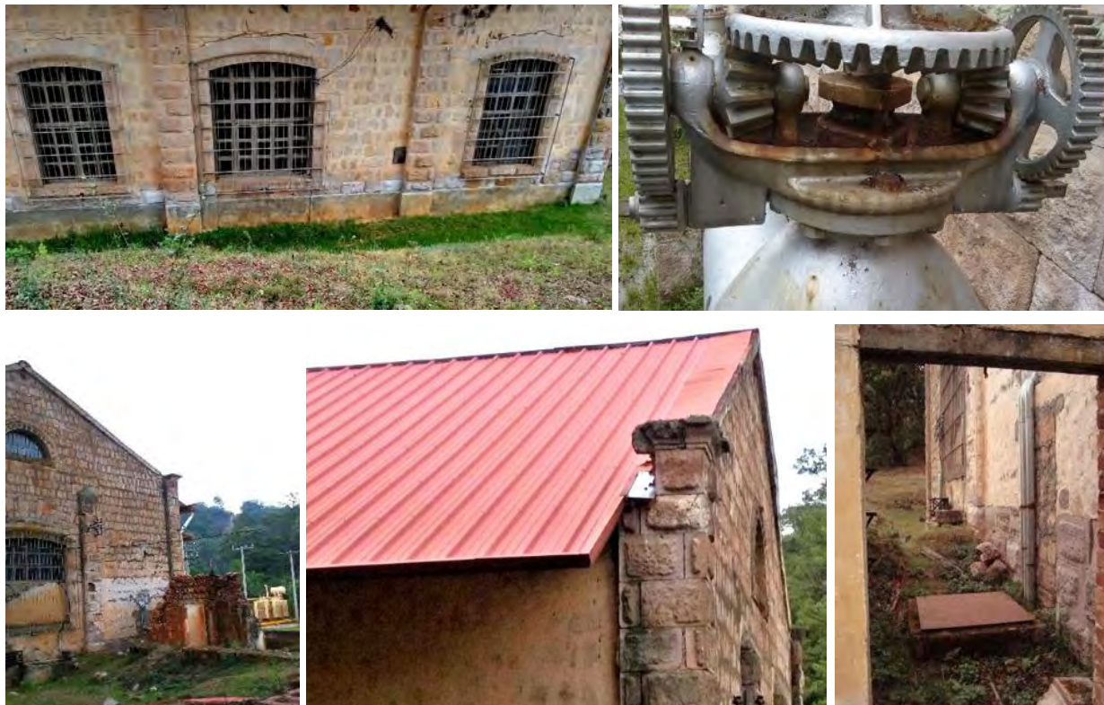
Figura 49: Deterioros de planta de luz hidroeléctrica, La Trinidad en 2017.
