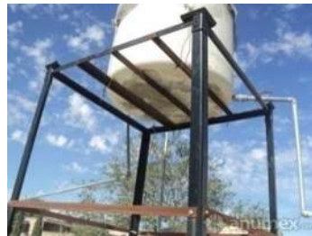
Figura 3.9 Tanque de almacenamiento de agua.
