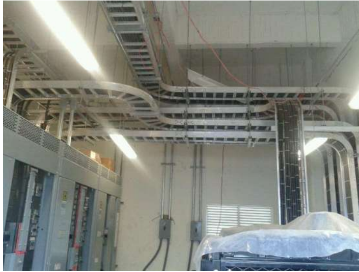
Figura 16.- Alimentadores Principales con Cable Unipolar en Soporte Tipo Charola
