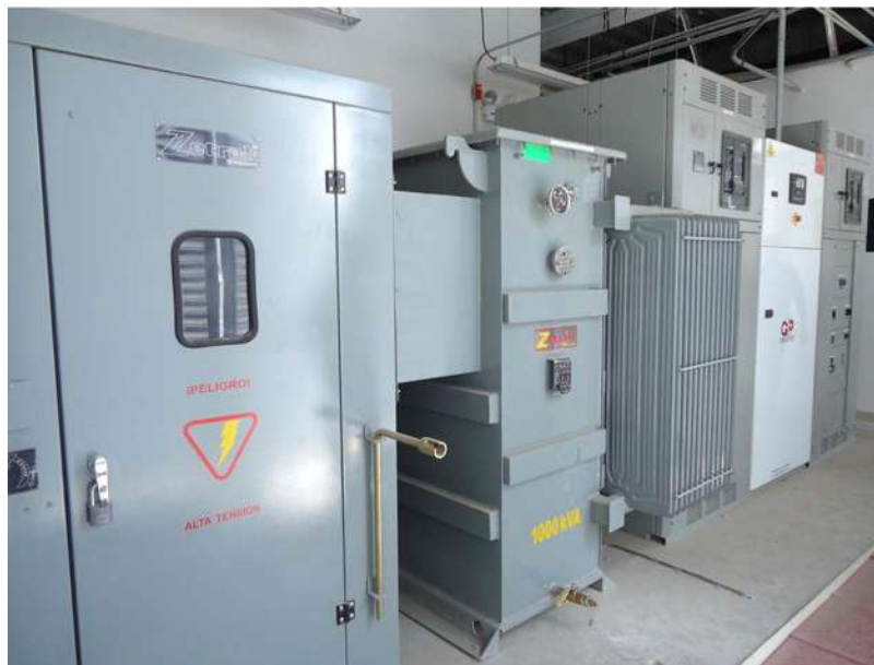
Figura 6.- Subestación de Distribución
