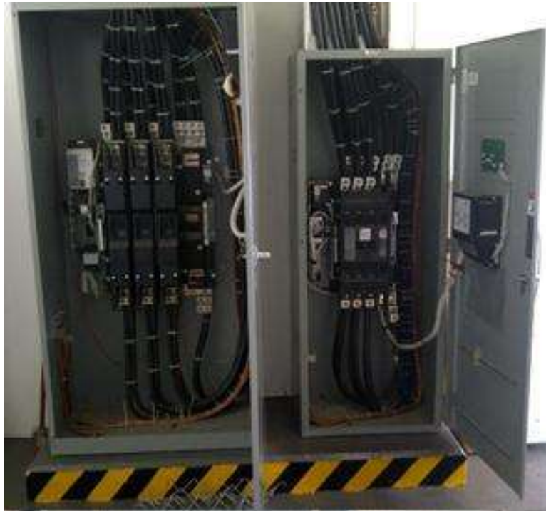
Figura 23.- Unidad de Transferencia Automática Doble
