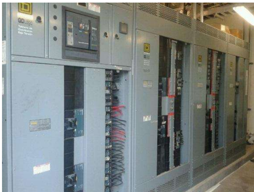
Figura 14.- Tableros Generales de Baja Tensión
