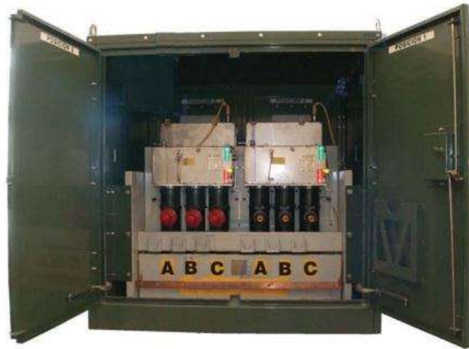
Figura 2.- Transferencia Automática Lado de la Fuente
