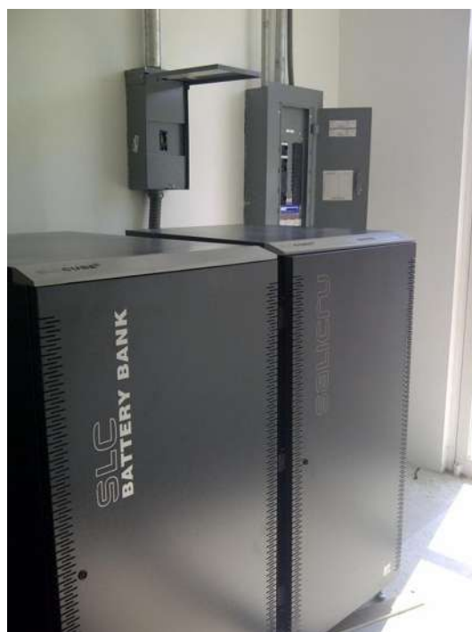
Figura 22.- Unidad Ininterrumpible de Energía (UPS)
