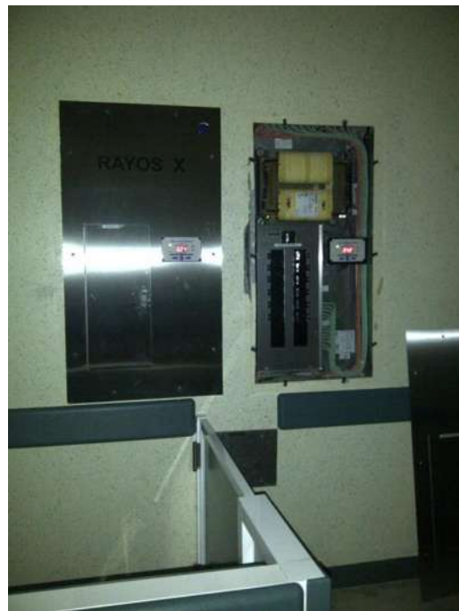
Figura 19.- Tablero de Aislamiento en Área de Quirófano
