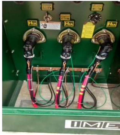
Figura 16.- Codo Operación Con Carga 200amp. e Instalación De Tierras
