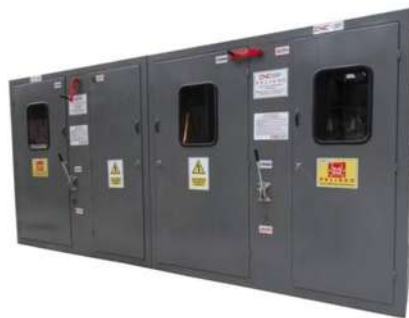
Figura 10.- Gabinete Celda de Medición y Cuchillas Seccionadoras en Grupo
