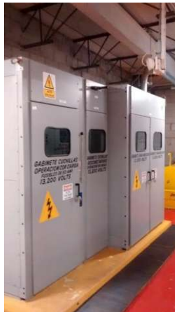
Figura 11.- Gabinete cuchillas Operación en Grupo Centro Comercial
