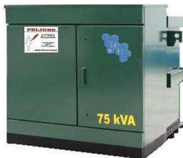
Figura 18.- Transformador De 75 Kva, 13200-127/220 Volts
