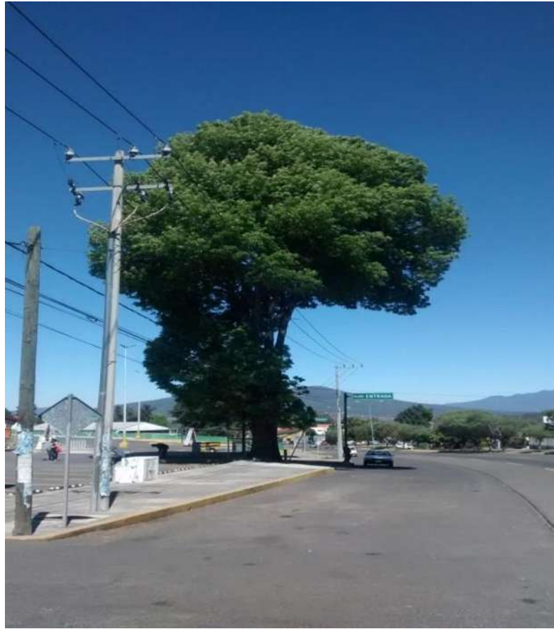
Figura 2.- Línea Semiaislada 15 Kv. 3f-3h Estructura TS30 Y Transición A Registro R1 De 1.5x1.5x1.5 Con Tapa De Hierro Fundido 84-B
