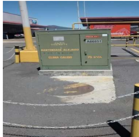
Figura 17.- Transformador De 75 Kva Norma K
