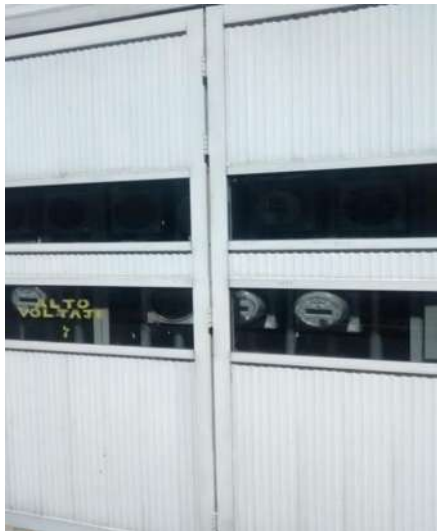
Figura 14.- Concentración de Medidores Del Centro Comercial
