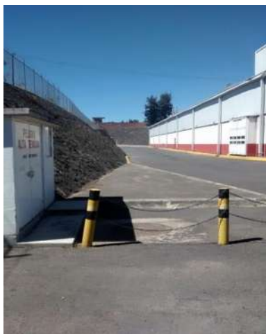
Figura 12.- Gabinete cuchillas Operación en Grupo Centro Comercial
