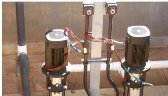
Figura 19.- Bombas Agua de Riego
