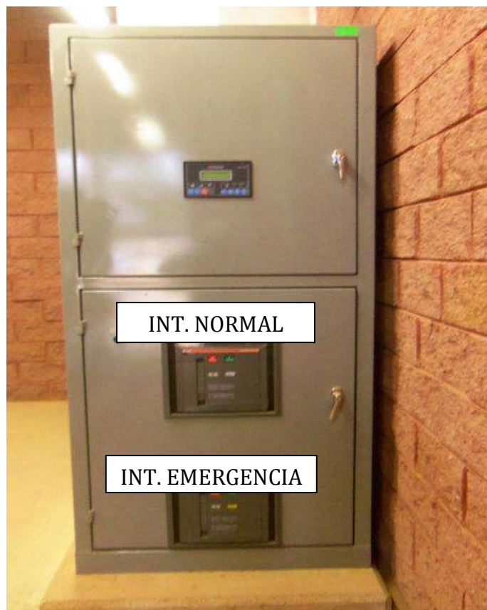
Figura 11.- Tablero de Transferencia
