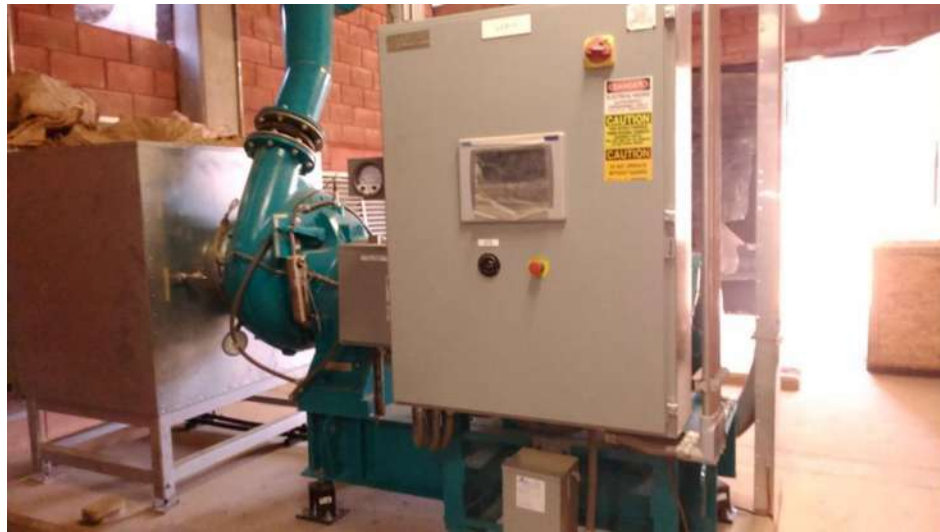
Figura 16.- Tablero de Control Soplador Turblex
