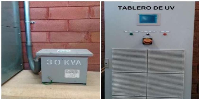
Figura 24.- Transformador y Tablero de Sistema de UV
