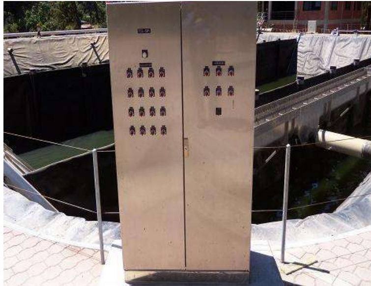
Figura 37.- Tablero de Control TCL-501
