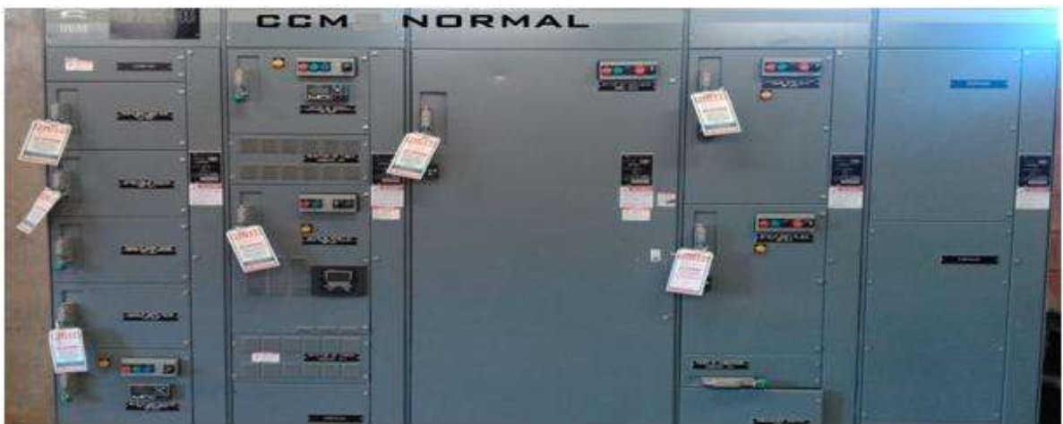
Figura 13.- Tablero CCM Normal
