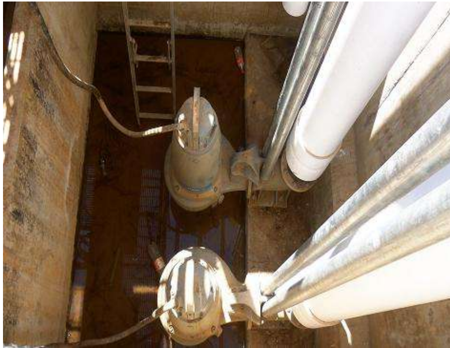
Figura 29.- Bombas de Agua Cruda MP-304 Y MP-305
