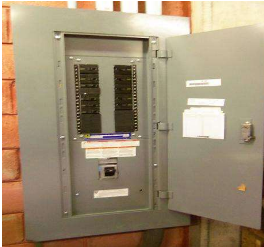
Figura 39.- Tablero de Distribución de Alumbrado
