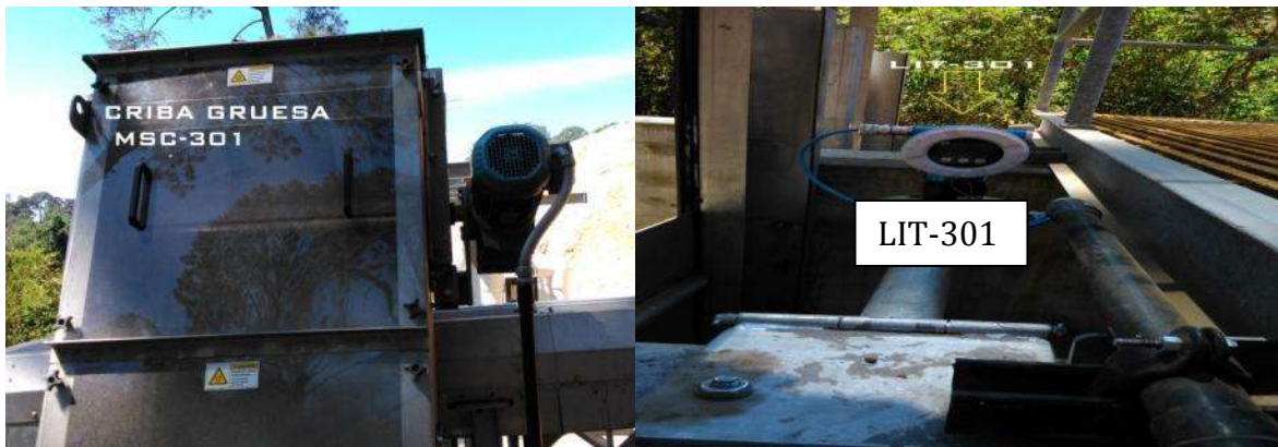
Figura 26.- Criba Gruesa y Medidor de Nivel
