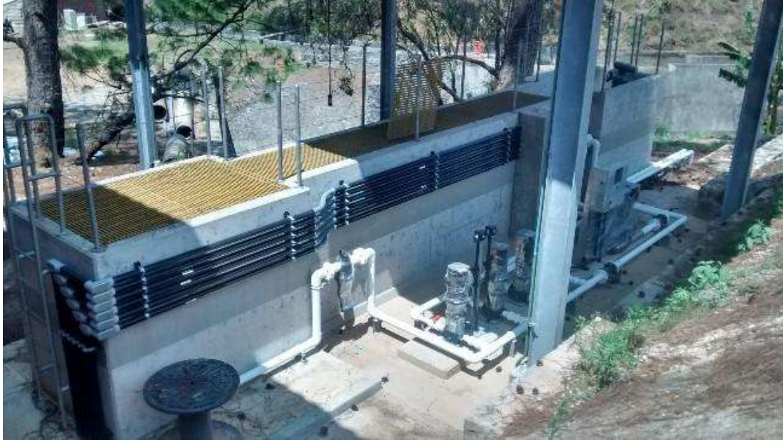
Figura 40.- Canal del Sistema de UV
