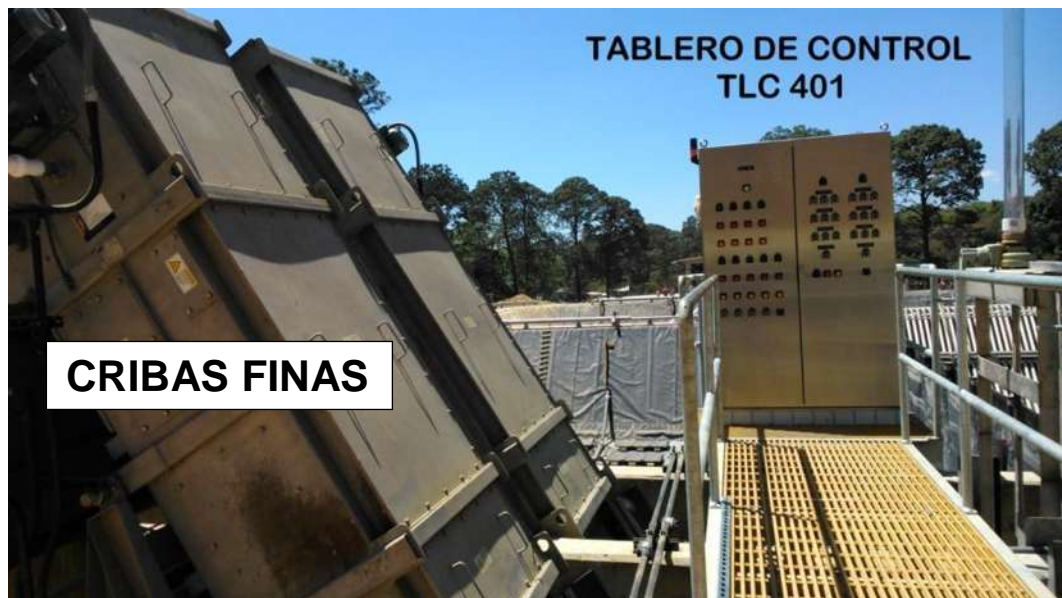
Figura 32.- Cribas Finas y Tablero de Control TCL-401
