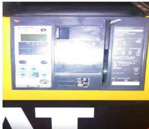
Figura 10.- Interruptor Principal Generador
