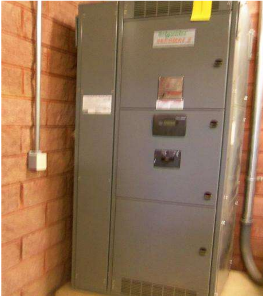
Figura 12.- Tablero Banco de Capacitores
