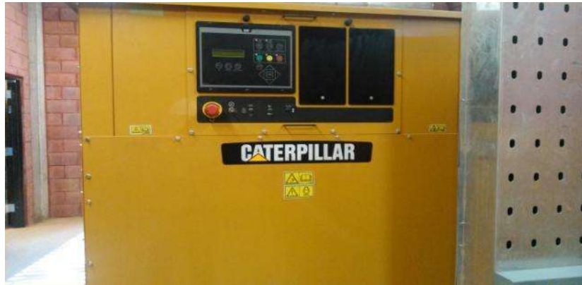
Figura 9.- Tablero de Control Generador
