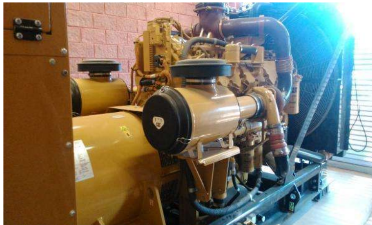
Figura 8.- Planta de Emergencia
