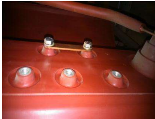
Figura 5.- Taps del Transformador
