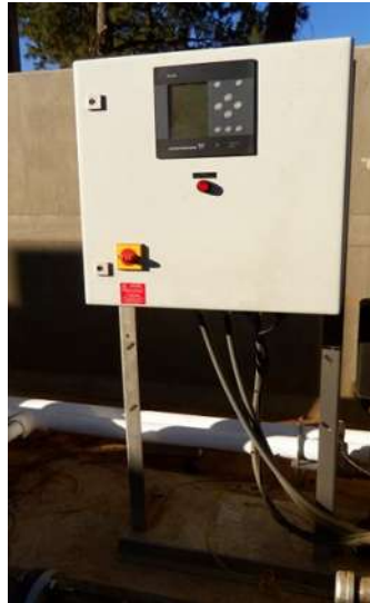
Figura 18.- Booster de Agua de Servicio
