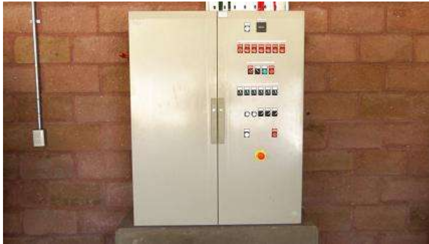
Figura 15.- Tablero de Lodos TCL-801
