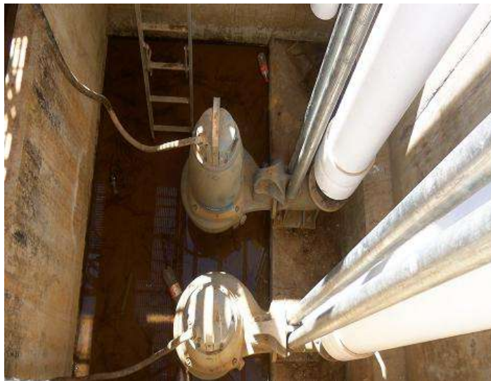
Figura 20.- Bombas de Agua Cruda
