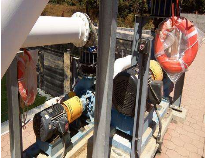
Figura 36.- Bombas de Recirculación
