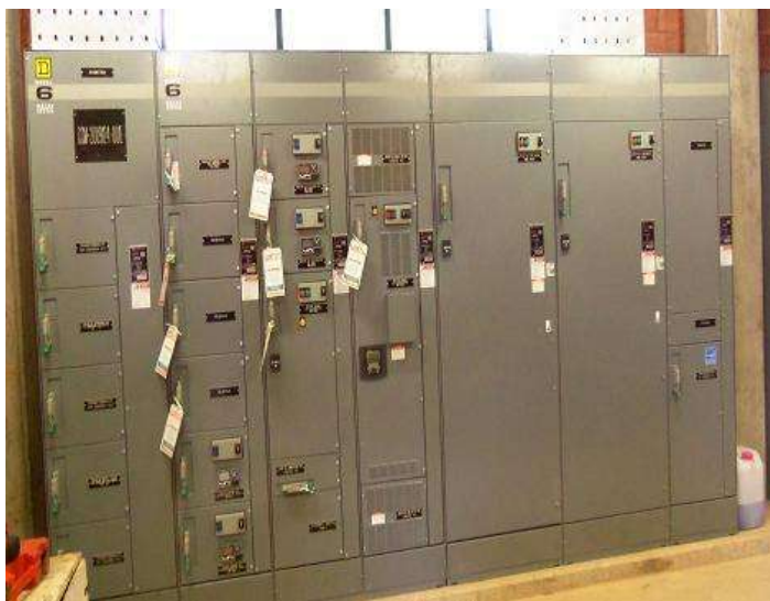
Figura 21.- Tablero CCM Emergencia
