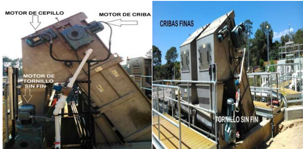
Figura 33.- Motores Equipos de Pretratamiento
