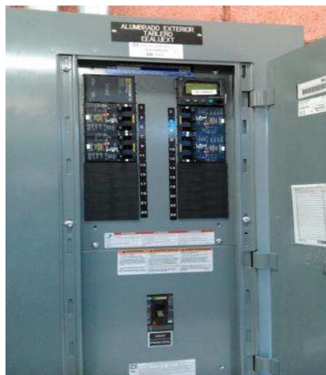
Figura 23.- Tablero de Alumbrado
