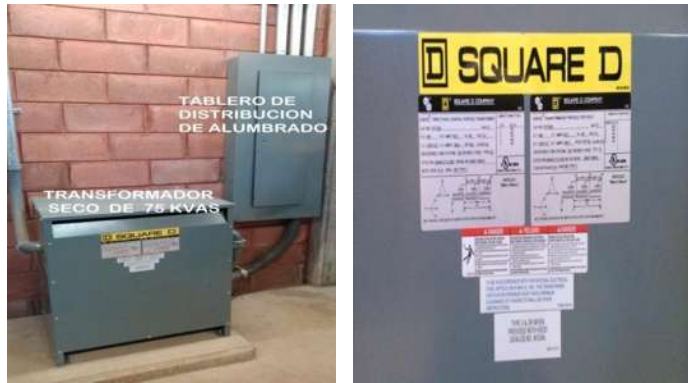
Figura 22.- Transformador de 75 KVA
