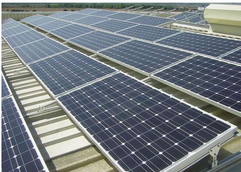
Figura 3.7 Paneles fotovoltaicos interconectados
