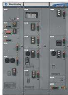
FIGURA 33.- CENTRO DE CONTROL MOTORES PARA MOTORES ARRANCADOR ESTADO SÓLIDO, 480V
