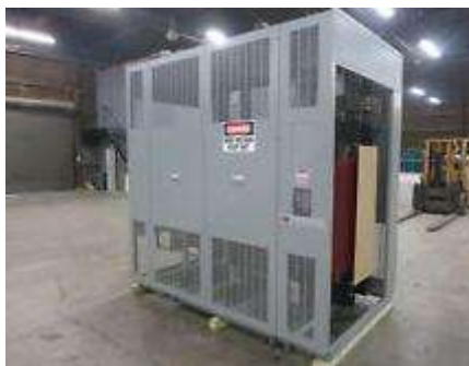
FIGURA 10.- TRANSFORMADOR TIPO SECO 13,800/480V, 3F 4H
