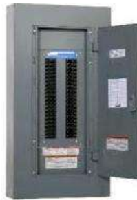
FIGURA 30.- TABLEROS DE DISTRIBUCIÓN DE ALUMBRADO Y CONTACTOS
