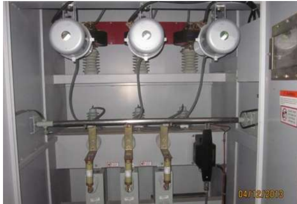
FIGURA 13.- BANCO DE CAPACITORES 13,800V FIJO
