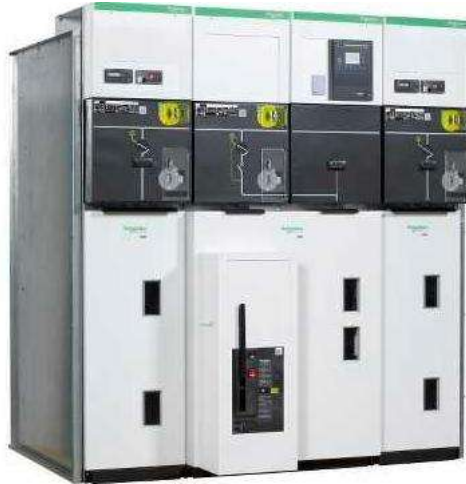
FIGURA 11.- ENLACE ANILLO HEXAFLORURO, Y ALIMENTADOR TRANSFORMADOR, DE 13,800V/480V, DE H
