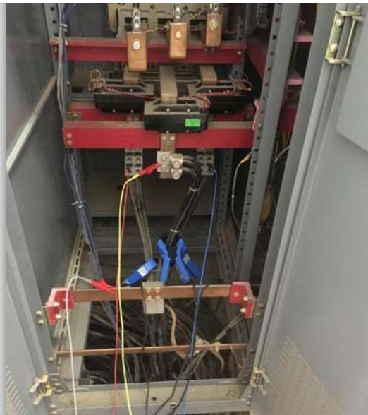
Figura C.2 Conexión de un analizador de armónicos al transformador trifásico de 300 KVA del lado secundario de la subestación de F.I.R.A
