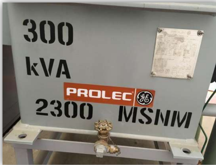
Figura C.1 Transformador trifásico de la subestación de F.I.R.A de capacidad de 300KVA
