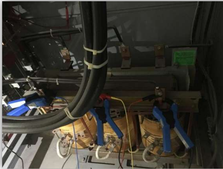
Figura C.4 Conexión de un analizador de armónicos en el transformador trifásico de 75 KVA del lado secundario localizado en el edificio A piso 3 de F.I.R.A
