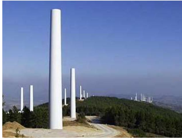
Figura 2.31 Aerogenerador con Torre Tubular.
