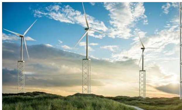
Figura 2.37 Aerogenerador tipo Torre de Celosía.
