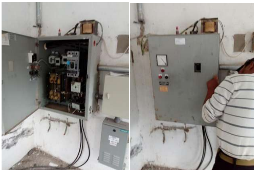
FIGURA 17.- CUARTO DE CONTROL DEL POZO PROFUNDO EN CHURINTZIO, MICHOACÁN.
