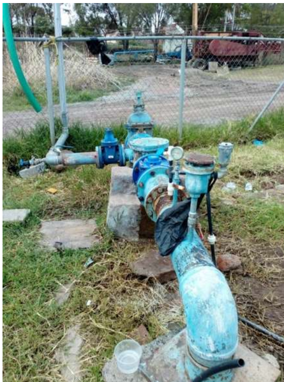
FIGURA 16.- POZO PROFUNDO EN CHURINTZIO, MICHOACÁN.
