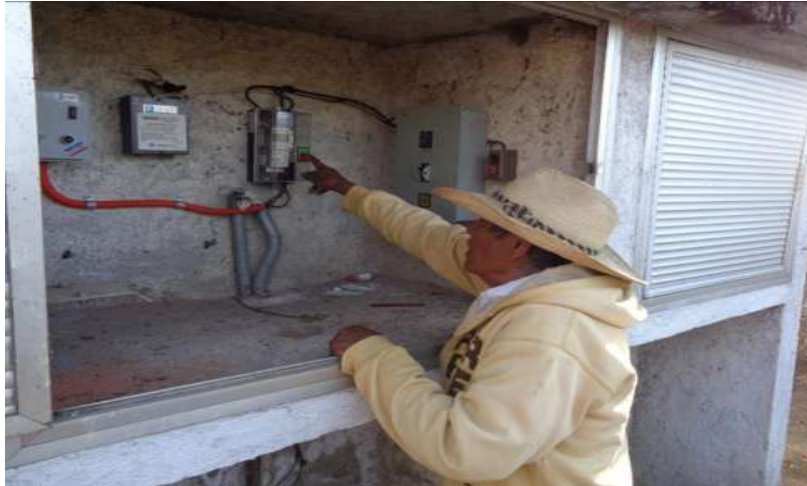
Figura 1. Caseta de control.
