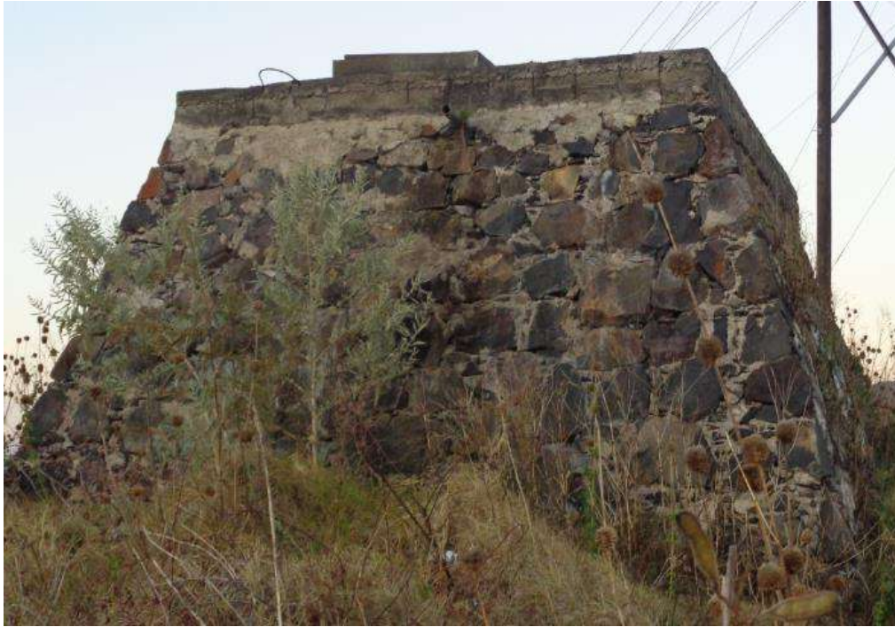
Figura 12. Depósito de agua.
