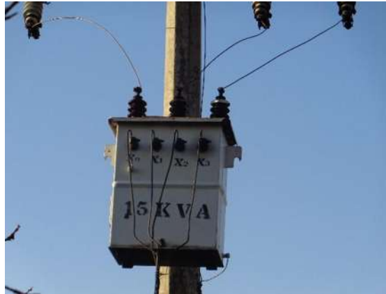
Figura 8. Transformador que suministra la energía.
