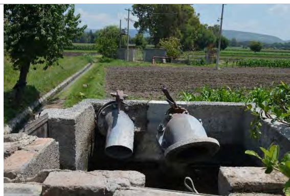
Figura 38. Pozo de absorción.
