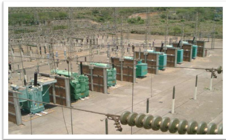
Foto 6. Banco de transformación en una subestación eléctrica.
