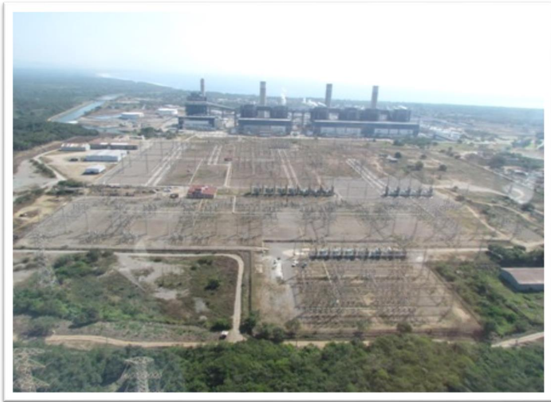
Foto 3. Vista aérea de la Subestación Lázaro Cárdenas Potencia.
