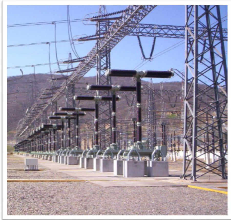
Foto 5. Interruptores de potencia en una subestación eléctrica.
