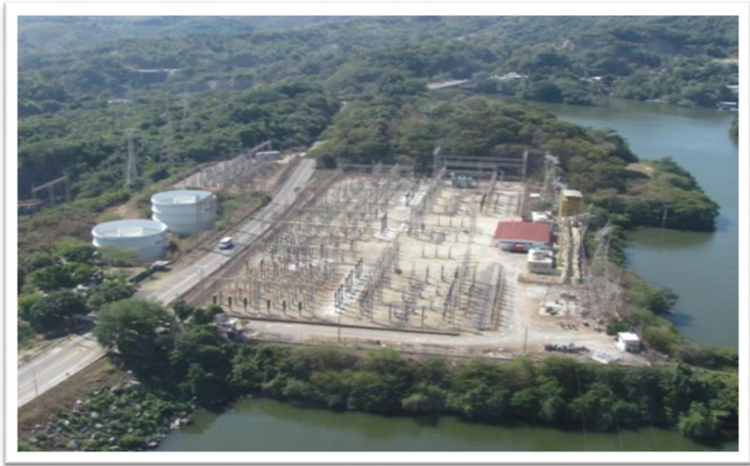
Foto 1. Vista aérea de la Subestación Villita.
