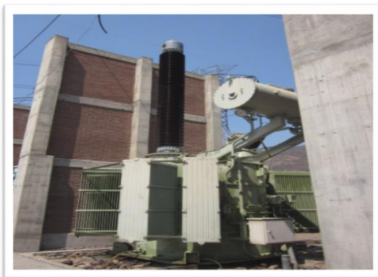
Foto 7. Banco de reactores en una subestación eléctrica.
