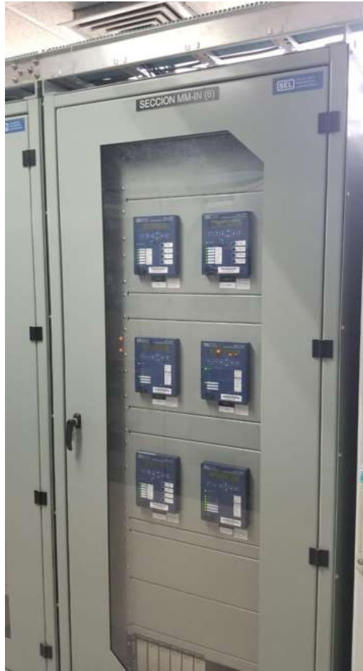
Foto 11 Gabinete con medidores de energía.
