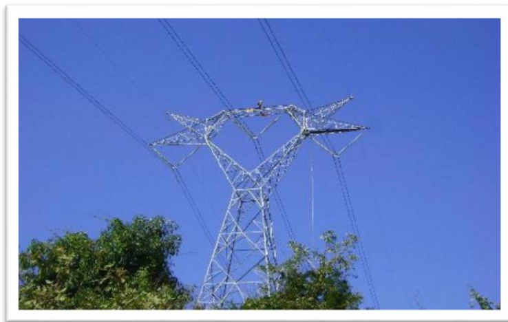
Foto 4. Estructura correspondiente a una línea de transmisión.
