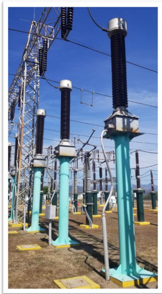
Foto 9. Transformador de potencial.
