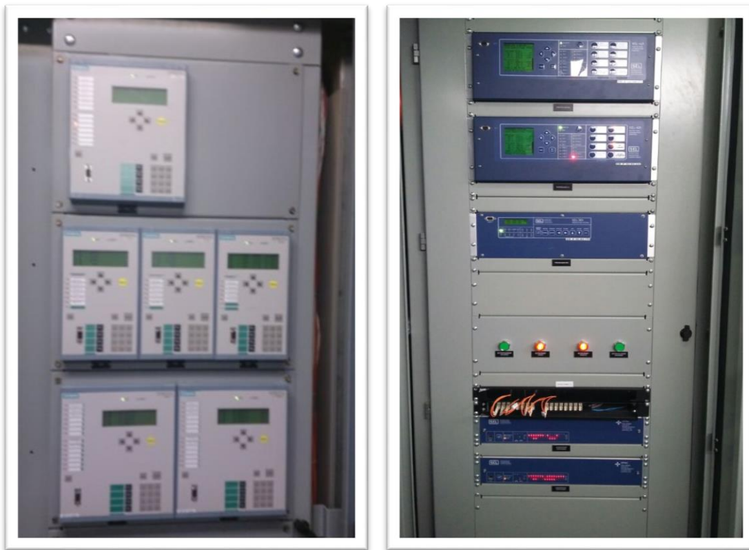
Foto 10 Gabinetes con relevadores de protección.
