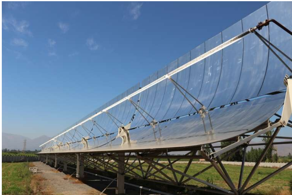
Figura 2.13. Sistema de energía solar de Jucosol con colectores solares cilindro parabólicos en Chile. (22)
