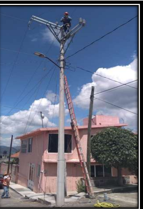
Figura 23: Estructura en media tensión VR3N.
