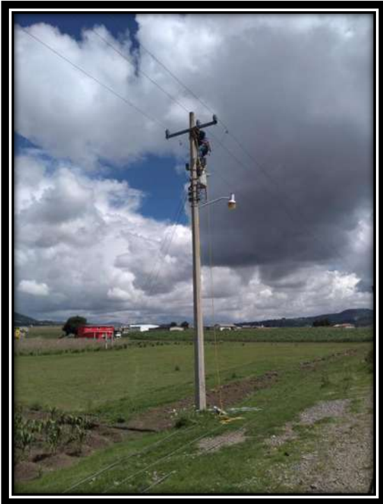
Figura 16: Estructura en media tensión TS3N.
