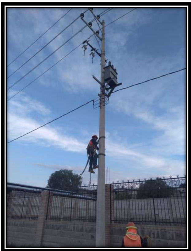
Figura 26: Estructura en baja tensión P4.
