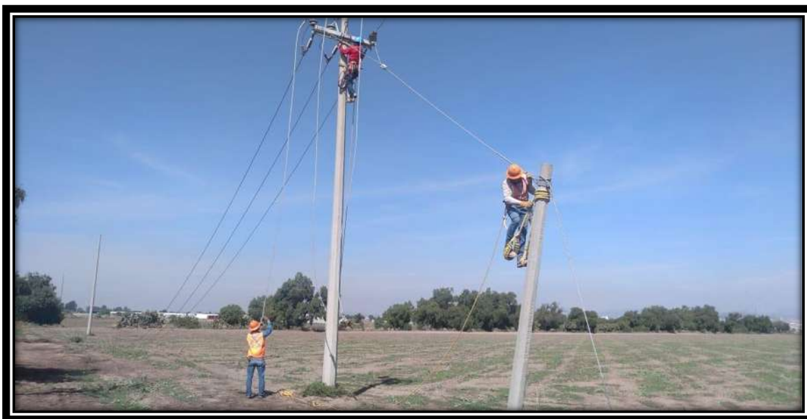
Figura 9: Poste de 12 m vestido con estructura RD3N con retenida tipo Estaca a Ancla (REA)
