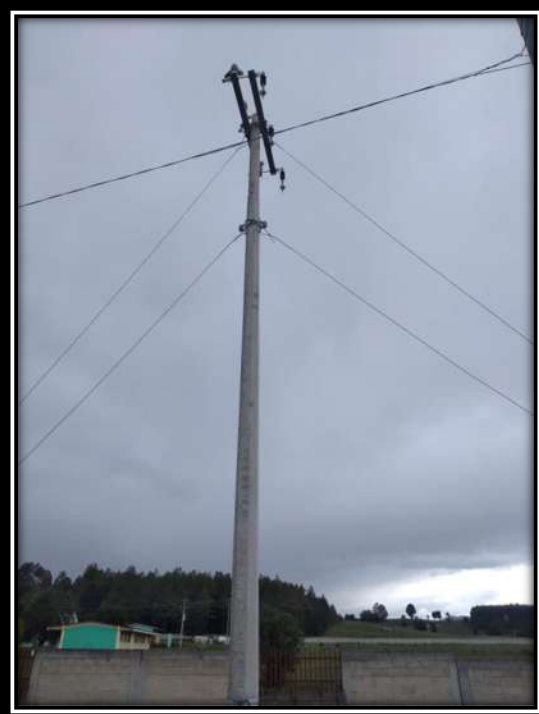
Figura 18: Estructura en media tensión AD3N.
