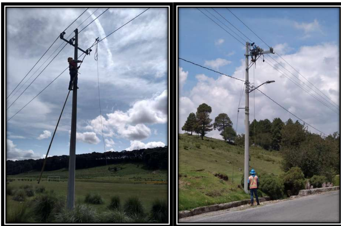
Figura 24: Estructura en media tensión TS3G, con hilo de guarda y apartar rayos tipo ALEA 13.
