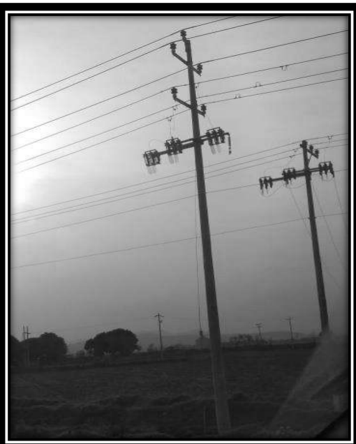
Figura 34: Instalación de Cuchillas de Triple disparo.
