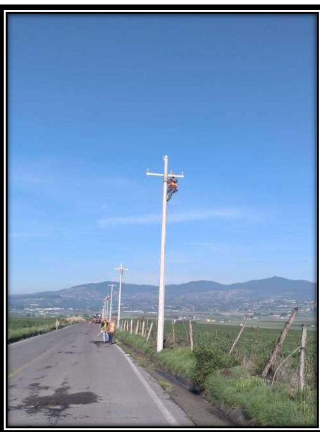
Figura 3: Poste vestido con estructura TS3G en segundo nivel, con hilo de guarda en primer nivel.
