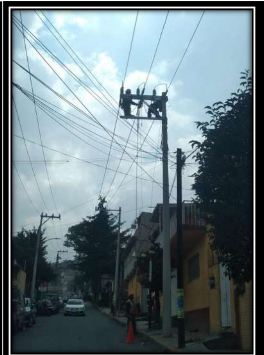
Figura 22: Estructura en media tensión VA3N.
