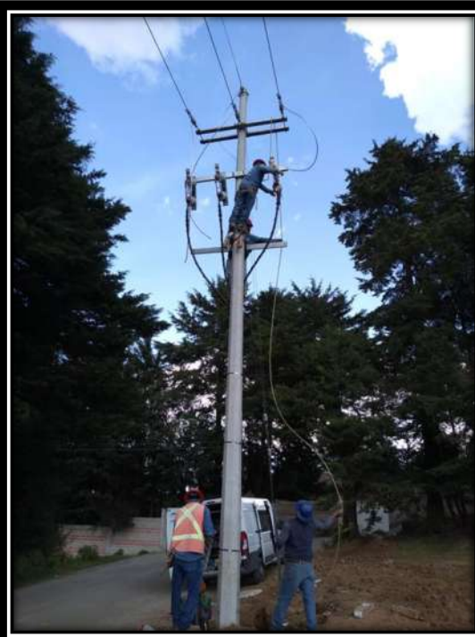
Figura 19: Estructura en media tensión RD3N.
