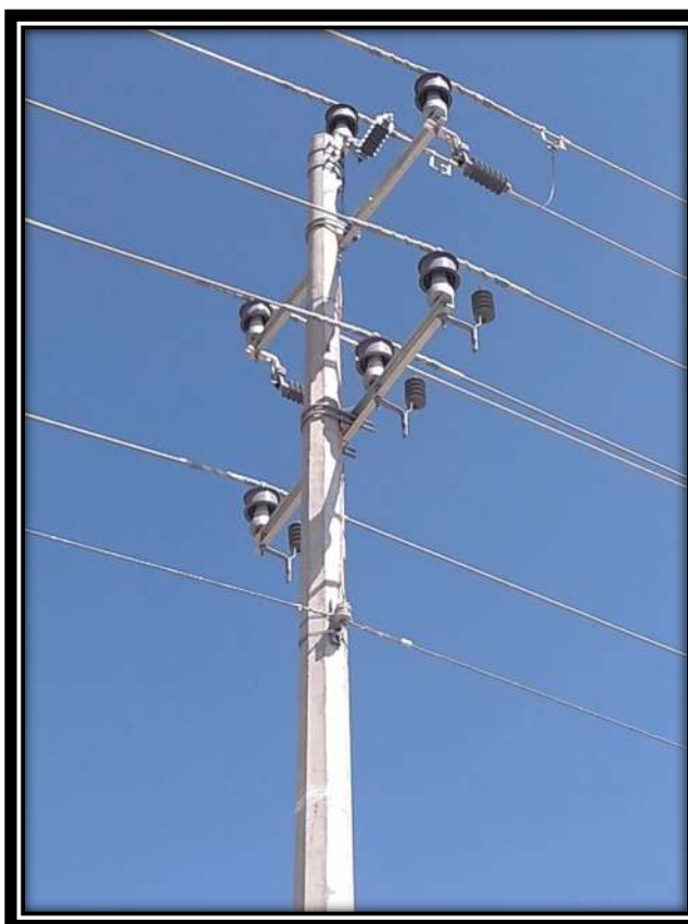
Figura 2: Poste vestido con doble estructura en media tensión.
