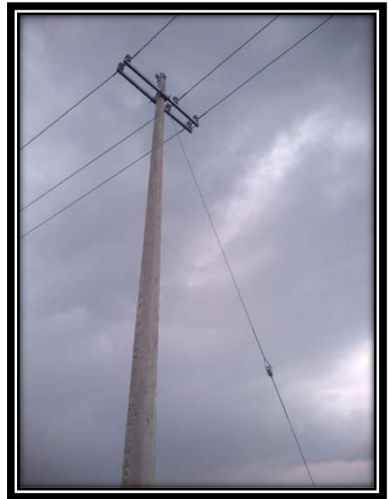
Figura 17: Estructura en media tensión TD3N.
