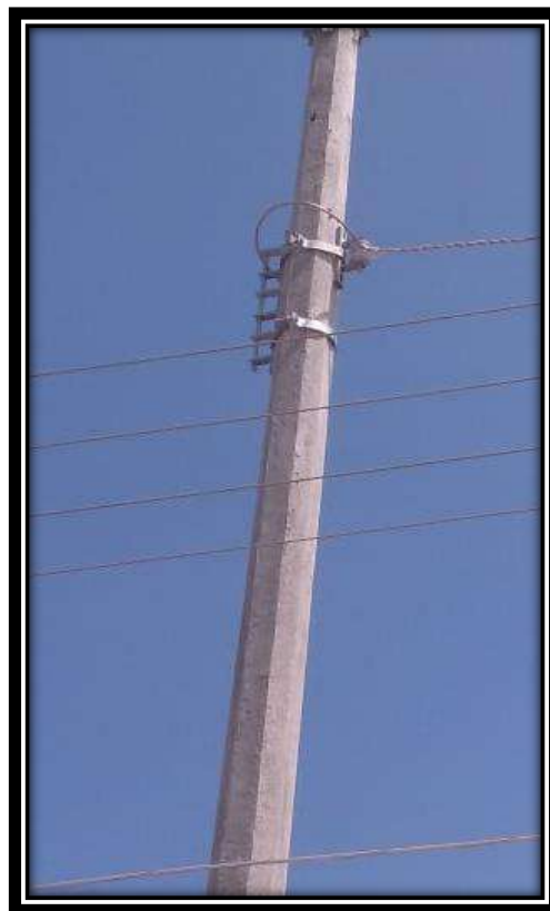
Figura 27: Estructura en baja tensión R3 Y R1.
