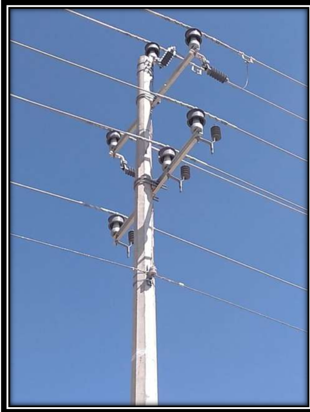
Figura 35: Apartarrayos ADOM-21 en primer nivel y ALEA23 en segundo nivel.
