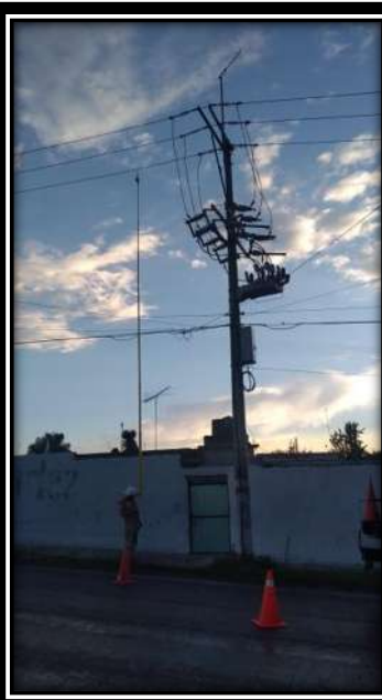
Figura 33: Operación de Interruptor Telecontrolado.
