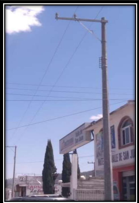
Figura 20: Estructura en media tensión VS3N.
