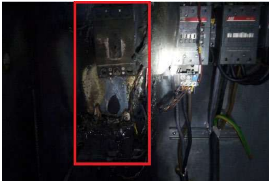
Figura 7.- Daños en un interruptor mal calculado
