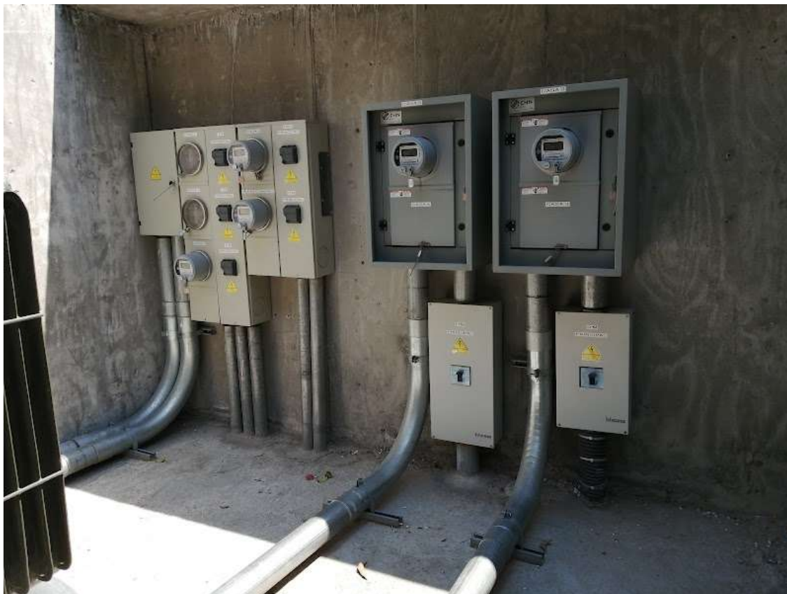
Figura 5.- Concentración de medidores
