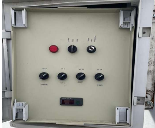
Figura 4.2.3 Tablero de Control de Motores.
