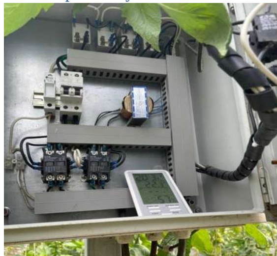
Figura 4.3.1. Tablero de temperatura y humedad
