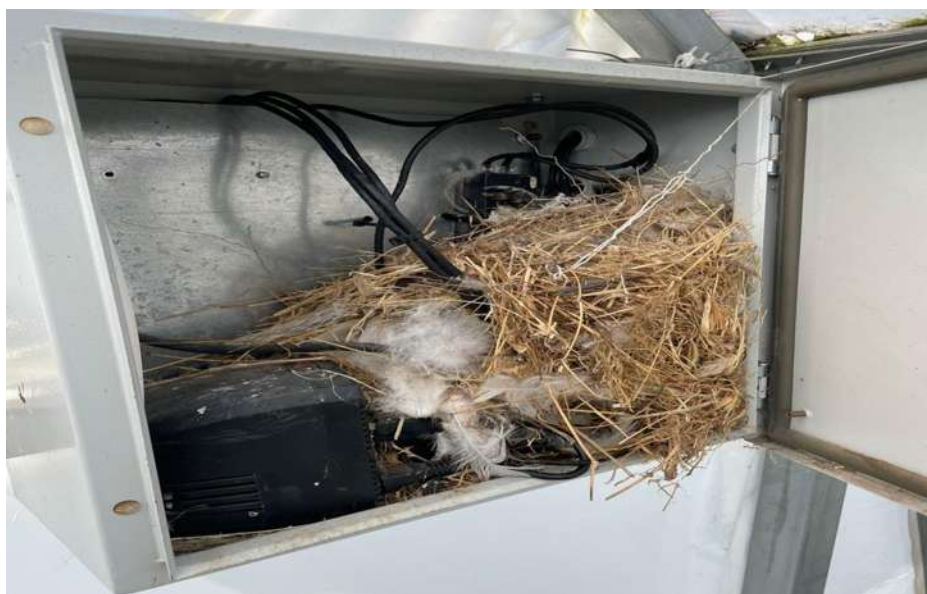
Figura 3.4.4 Gabinetes al descubierto
