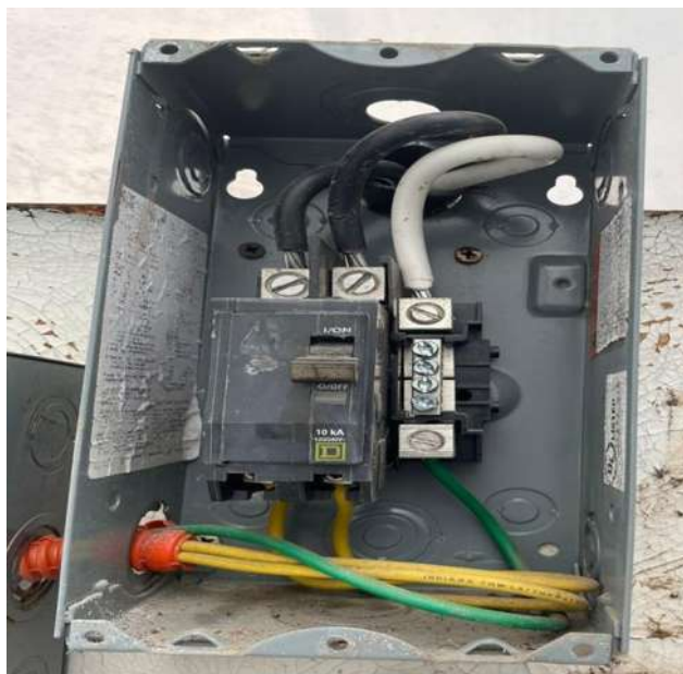
Figura 4.1.4 Centro de carga.
