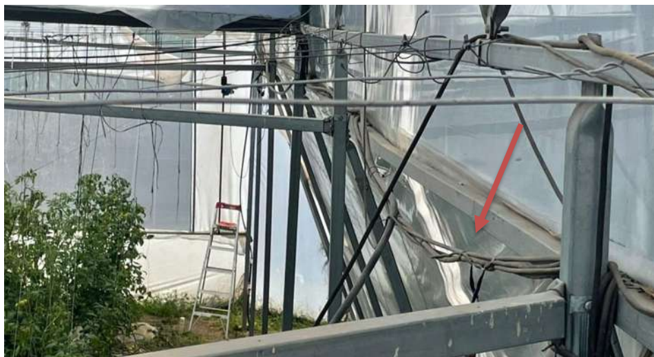
Figura 3.4.5 Cables eléctricos colgando.
