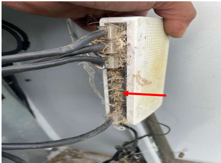
Figura 3.4.8 Puertos de conexión llenos de basura.
