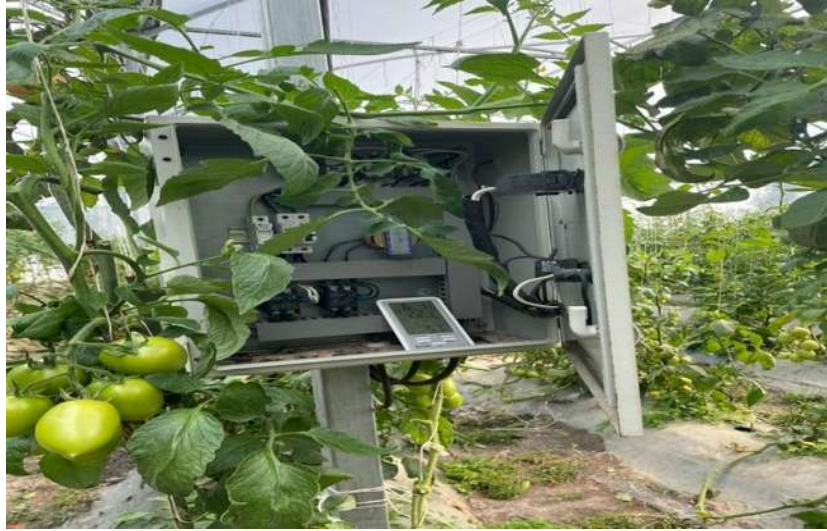
Figura 3.4.2 Tablero de ventiladores abierto
