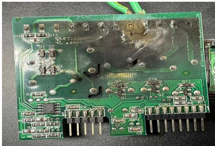
Figura 3.3.2 Daño en el circuito del sensor
