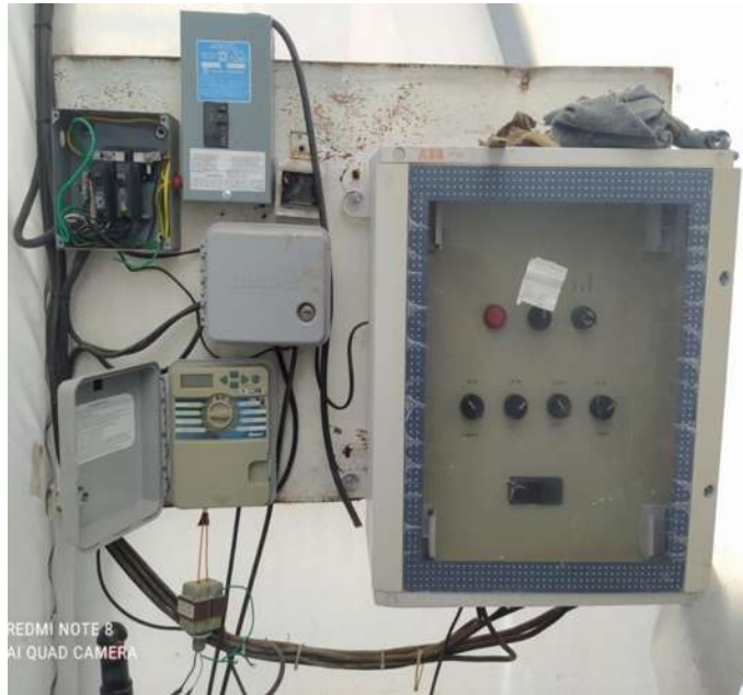
Figura 3.1.4 Tablero de control de motores
