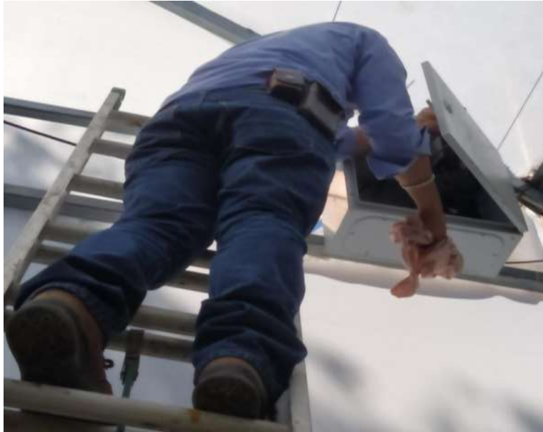
Figura 4.1.2 Proceso de mantenimiento a gabinete.
