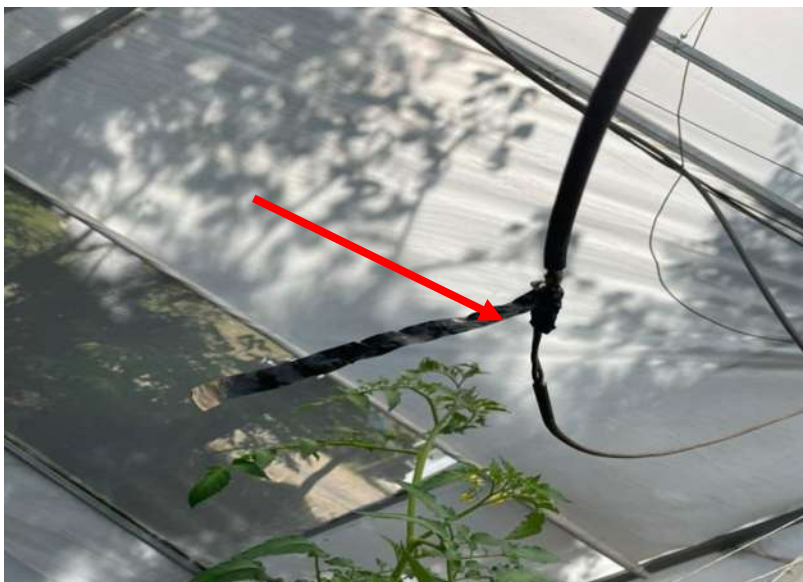
Figura 3.4.3 Conexiones eléctricas en mal estado
