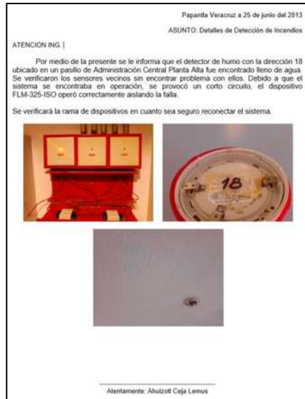
Figura 5.5 Reporte por daño de agua en sensor
