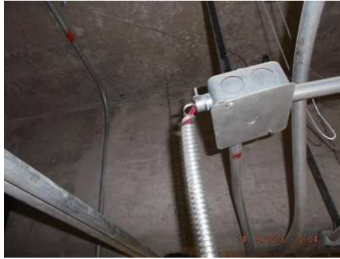
Figura 5.9 Corrección de tubería tipo zapa de 1/2" dañada por mala instalación
