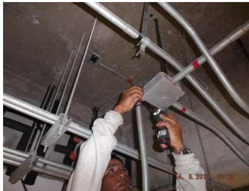
Figura 5.10 Corrección de tubería tipo zapa de 1/2" dañada por mala instalación (continuación)
