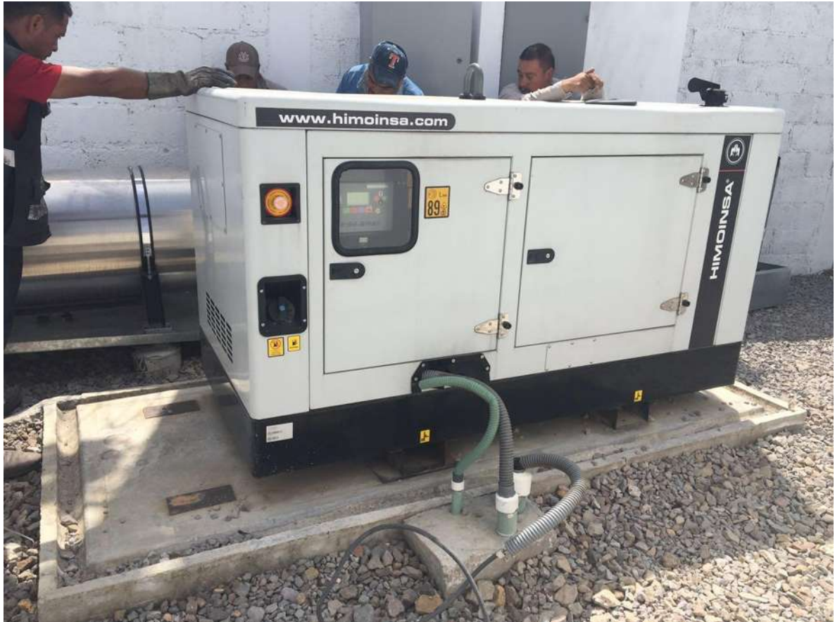
FIGURA 5.- INSTALACIÓN Y CONFIGURACIÓN DE GENERADOR DE LUZ.
