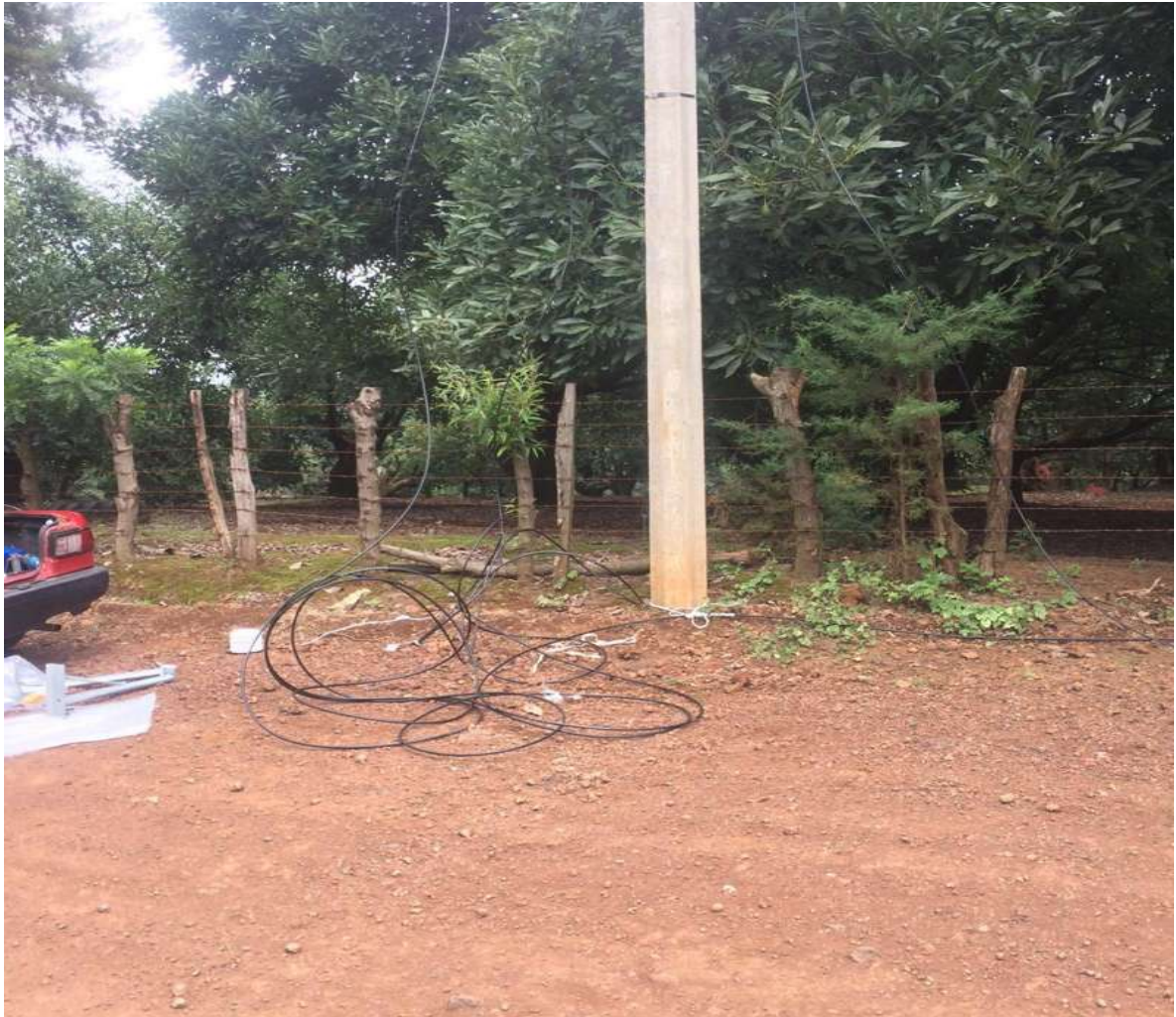
FIGURA 6.- REPARACIÓN DE CORTE DE FIBRA ÓPTICA DE SITIO GTAC CARAPAN A CFE URUAPAN
