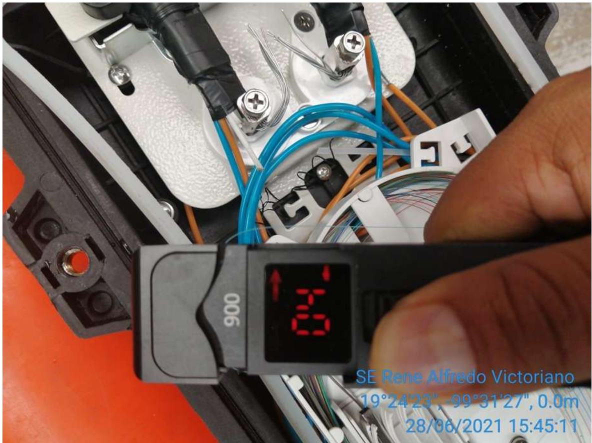
FIGURA 34.- MEDICION DE DIRECCIÓN DE POTENCIA ÓPTICA.
