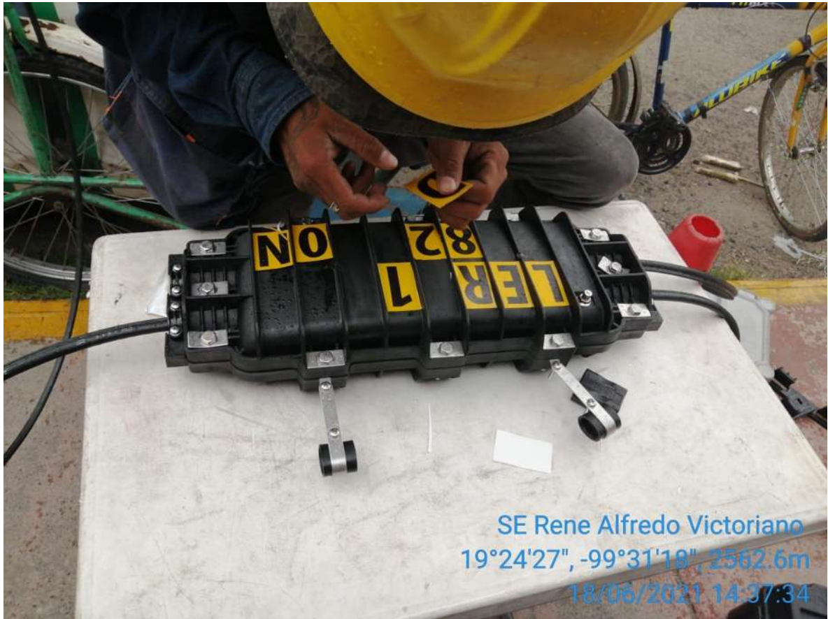
FIGURA 37.- ETIQUETADO DE CIERRES DE EMPALME.
